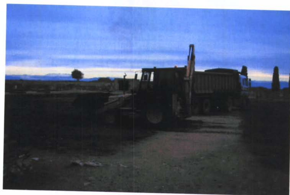
Fig. 2. A dalt, aspecte de la plaça abans de començar les obres. A sota, inici de les mateixes.
