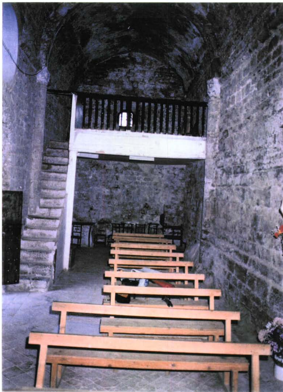
SANTA MARIA DE VIU DE LLEVATA INTERIOR. PARET DE PONENT I COR.
