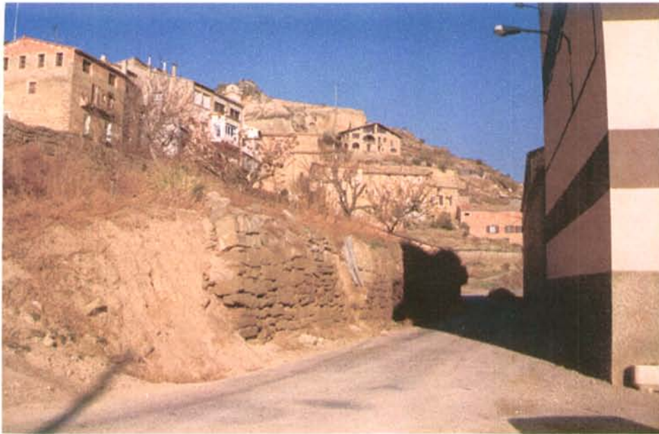
Detall del mur de contenció de les feixes al peu de la carretera vella
