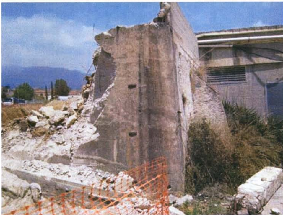
IMATGE 6. Murs de formigó que afecten i aprofiten el mur perimetral. Vista d'un contrafort.
