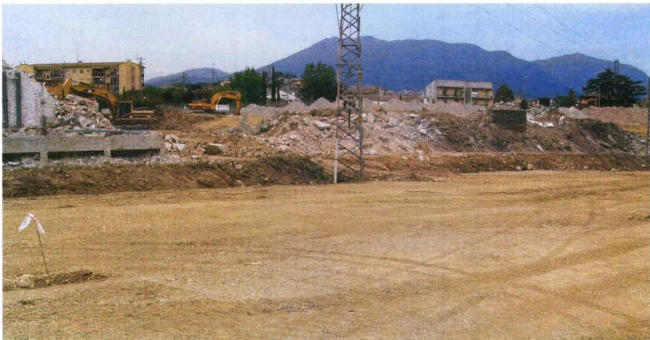
IMATGE 1. Conjunt del solar des del sud a l'inici de les obres. Límit de les plataformes, estació transformadora i caldera.
