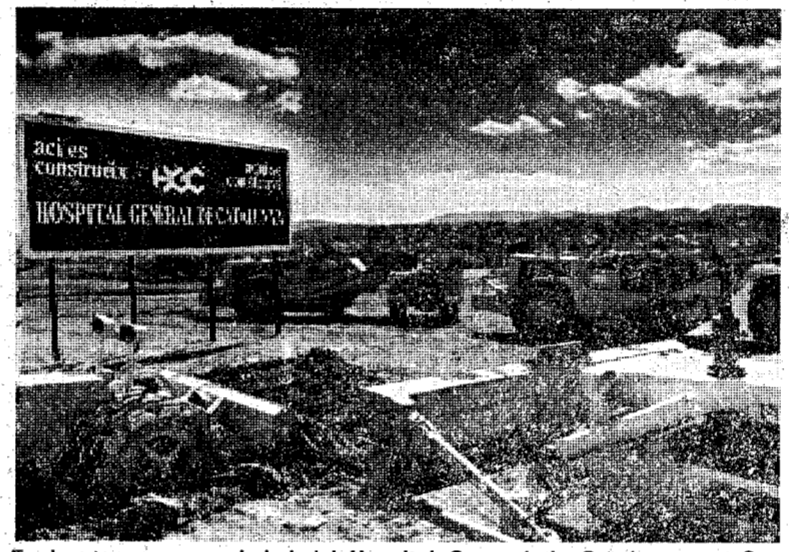
En los terrenos propiedad del Hospital General de Catalunya, en Sant Cugat del Vallés, se han iniciado el día 12 de marzo último, las obras de Urbanización para la edificación del Hospital. La fotografía muestra un aspecto de los trabajos del movimiento de tierras.
