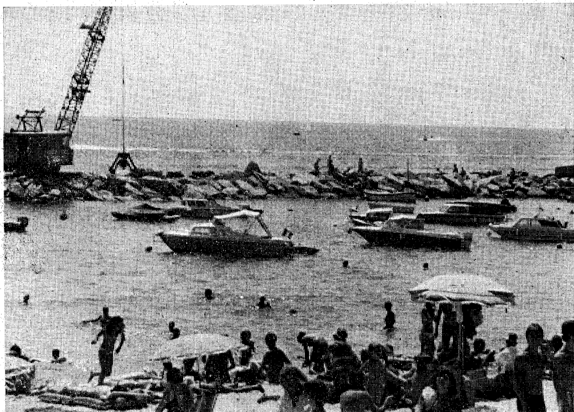
Mientras continúan los trabajos de recuperación de la playa de Sant Antoni de Calonge, el Ayuntamiento ha ultimado el proyecto del Paseo Marítimo, que se estima costará cincuenta millones de pesetas y que culminará estos trabajos que permiten garantizar el futuro de una de las playas más singularmente bellas de la Costa Brava. (Foto Pablito).
