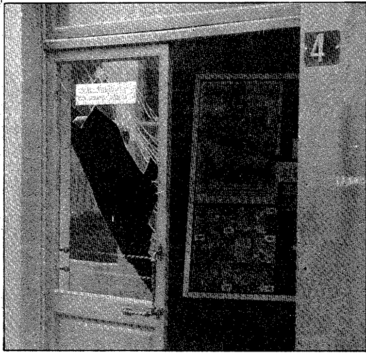
Los cacos se introdujeron en el local por la entrada posterior para evitar la alarma instalada en la entrada principal. (Foto M.C. DARANAS).
