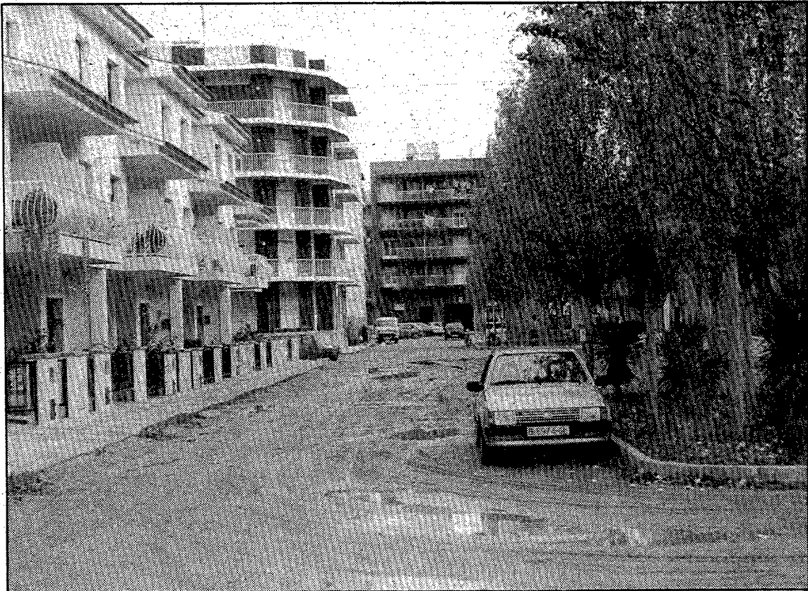
Les obres de pavimentació i renovació de clavagueram de la Plantera de Blanes superaran els vuitanta milions de pessetes. (Foto DAVID QUINTANA).
