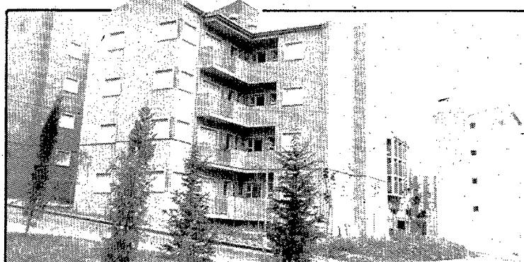
Los vecinos de Vila-roja, preocupados por el estado de sus viviendas.
