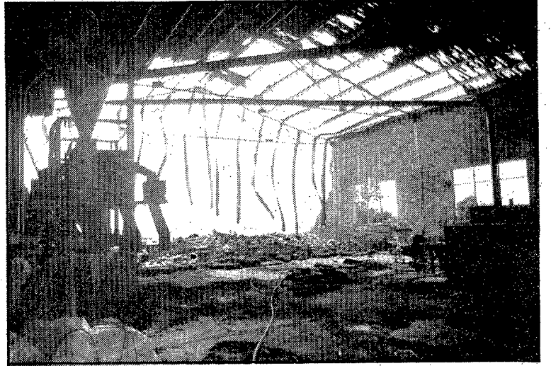
La fábrica tras el incendio. (Foto DAVID QUINTANA).
