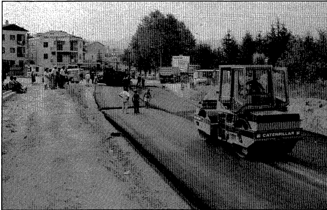
La construcció de la carretera ha suposat obres considerablement costoses, com es comprova a la fotografia presa en plena construcció del nou traçat.
