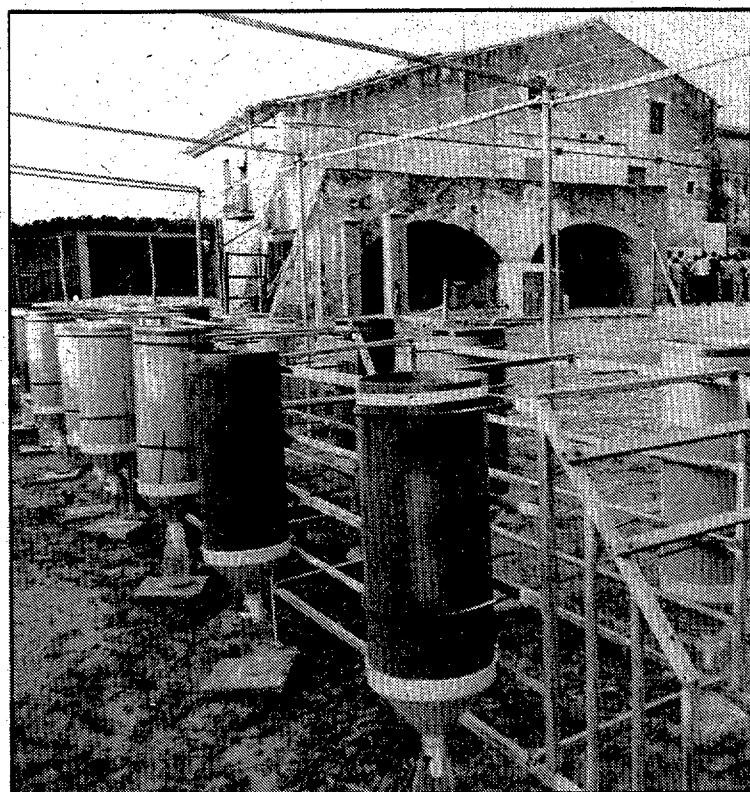
Mas Badia disposarà aviat d'una planta d'assecatge agrícola que funcionarà amb energia solar. (Foto DANI DUCH)
