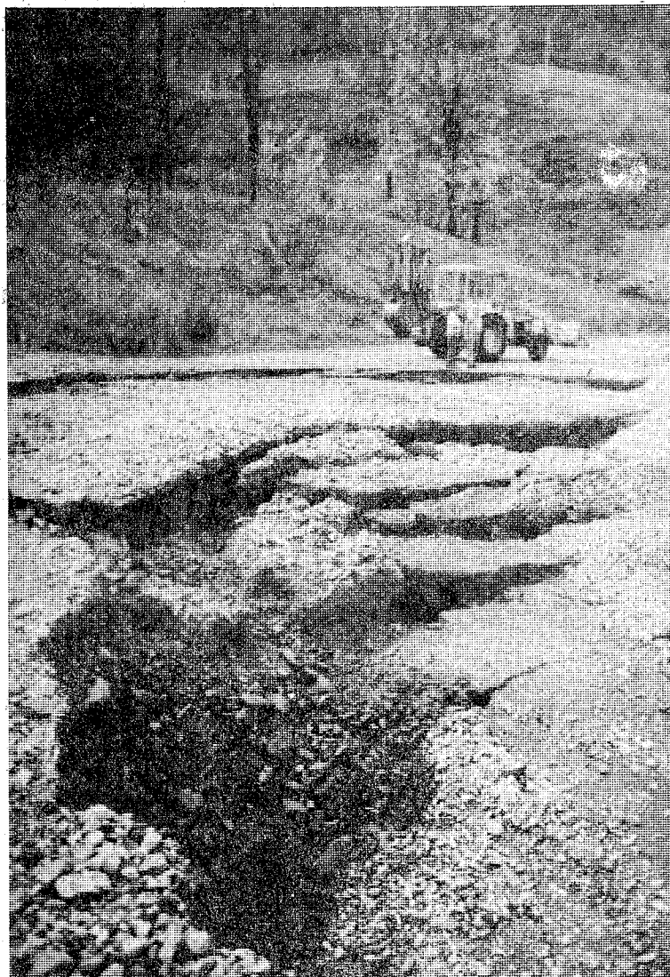
Socavón en la carretera internacional de «Coll d'Ares» en su tramo lindante al Club de Tennis y Font Nova. (Foto Coma)
