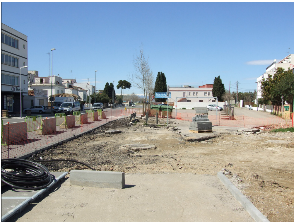
Fig. 34.- Vista de la zona de la cruïlla entre l' Avinguda de Rhode i el carrer Comapedrosa un cop finalitzades les tasques de retirada de la pavimentació existent.
