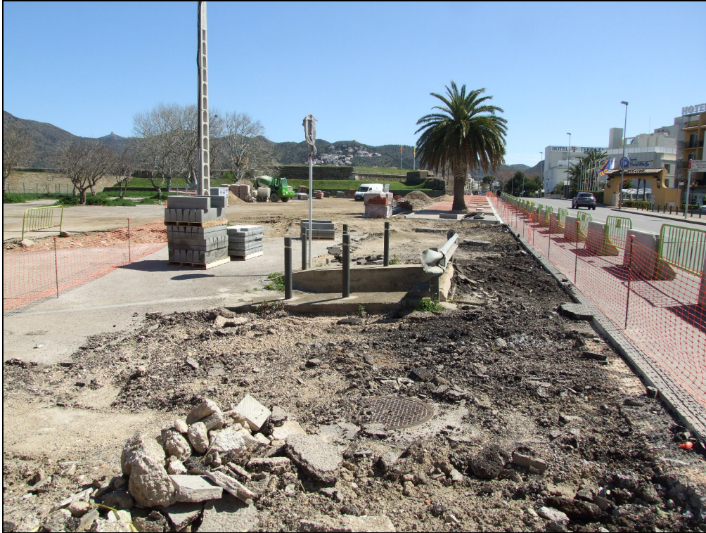
Fig. 33.- Vista de les tasques d'aixecament de la pavimentació existent a la cruïlla entre l' Avinguda de Rhode i el carrer Comapedrosa.
