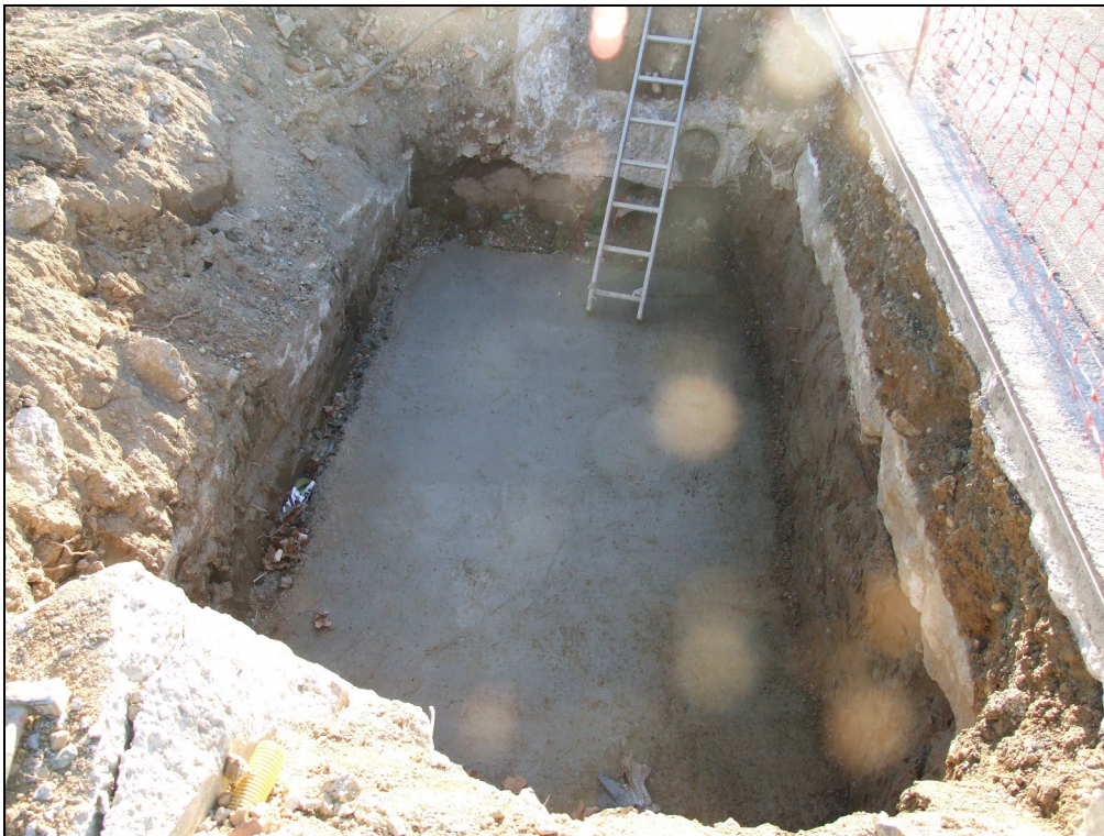
Fig. 27.- Vista del tercer sondeig realitzat, s'observa l'antiga línia de pavimentació de l'avinguda de Rhode i les restes de construcció de xarxes existents de construcció recent.
