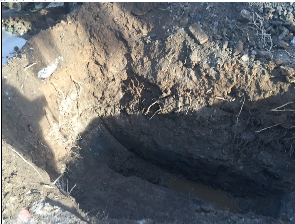
Fig. 24.- Vista del perfil del primer sondeig realitzat. S'observen successives capes d'amortització de terres. A uns dos metres de fondària la capa freàtica va afectar la base del sondeig.
