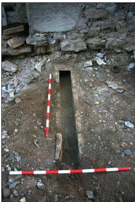
Foto 20. Petita canalització de l'immoble enderrocant, que connecta amb la xarxa de clavegueram principal
