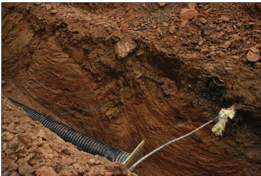
Fotos 10 i 11. Excavació de la rasa per substituir la xarxa de clavegueram.
