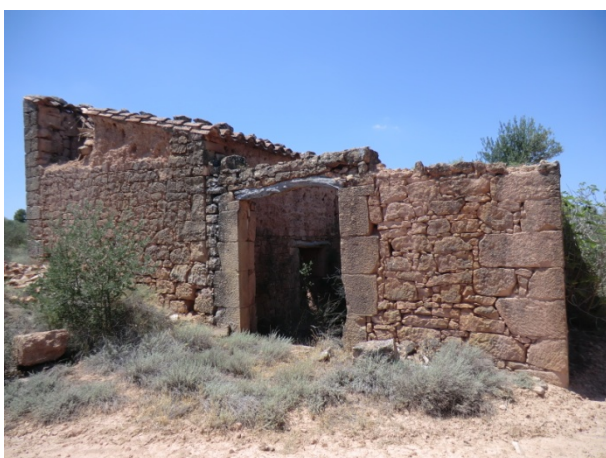
3. Corral parcialment enrunat anomenat corral de la Joana (PI-21).
