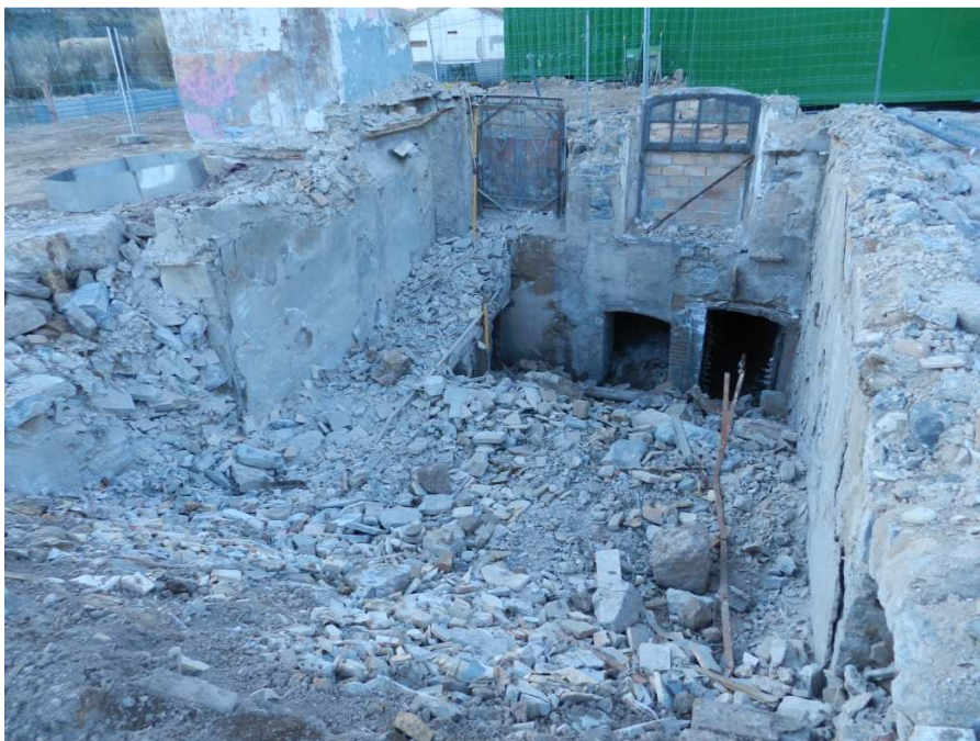
Sala de calderes, després de la caiguda de la volta
