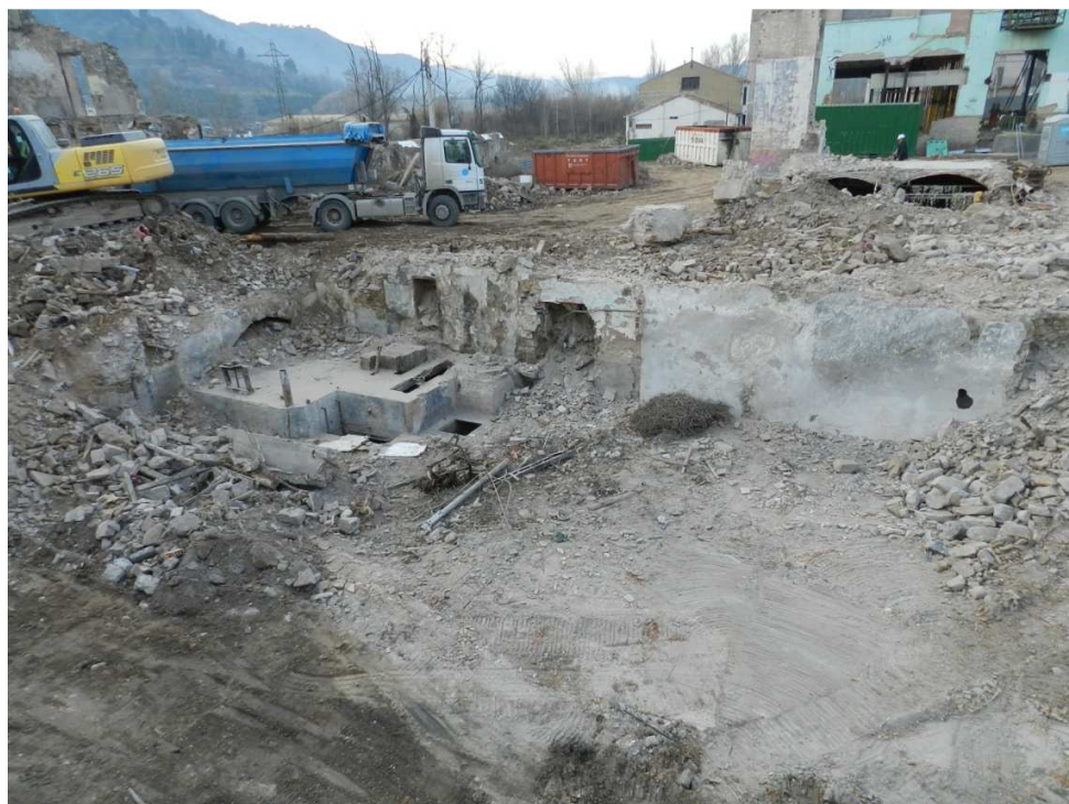
Sala de la turbina
