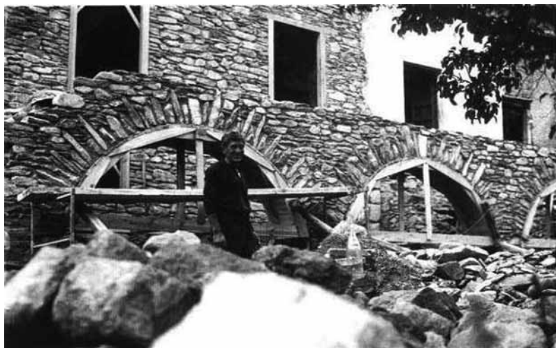
Joan Isern, en una obra a Ger, cap a la dècada de 1960. Arxiu de Cal Jet.
