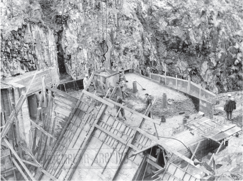
Construcció de la presa de Tavascan. Autor desconegut. Any: 1961. Arxiu Nacional de Catalunya (Fons Fecsa).
