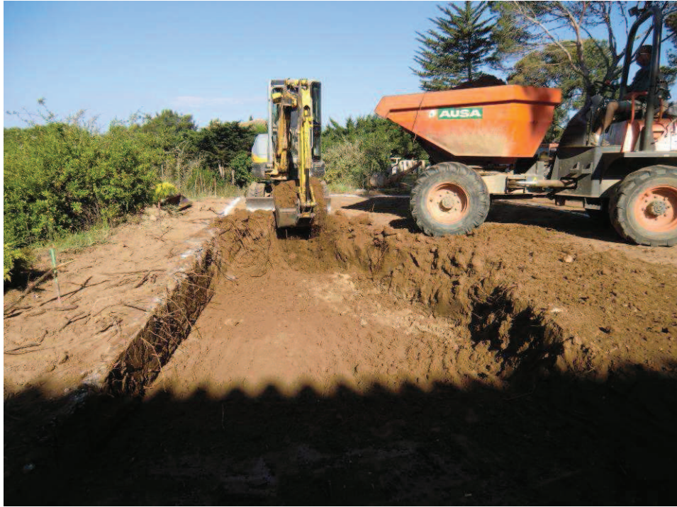
Fig. 5. Rebaixos mes profunds dels costat oest.
