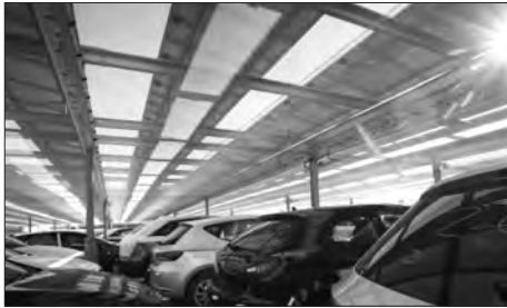
Pàrquing fotovoltaic de SEAT, Martorell.
