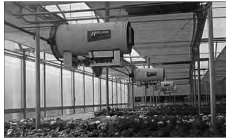
Hivernacle amb energia geotèrmica, Holanda.
