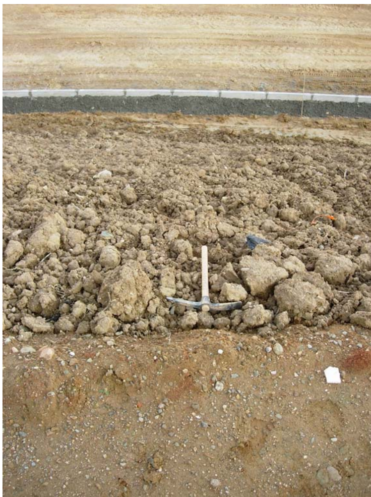
Fotografia en què s'aprecia el gruix de terra vegetal emplaçada sobre el talús per tal d'estabilitzar-lo i ajardinar-lo. Aquesta pràctica, realitzada amb manifesta cura, ha emmascarat la informació geològica que es podria haber extret. A la part de sota del talús s'observen els treballs d'urbanització del polígon. La picola serveix d'escala gràfica aproximada.
