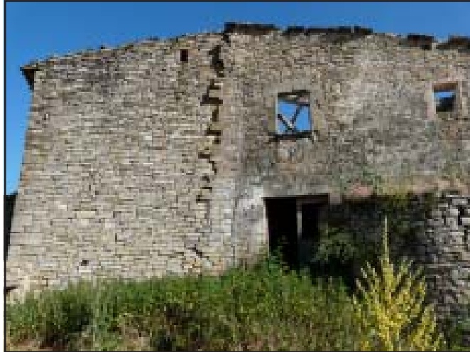
Vista de la façana nord. S'observa la reconstrucció que va patir tota la banda est del cos principal del castell (a l'esquerra)
