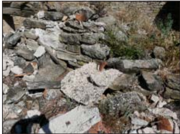
Restes del basament del mur de tancament sud del cos occidental (MR-5)
