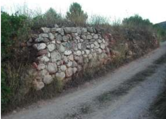
Foto 7. Detall dels marges de pedra seca, a la vora del camí oriental que voreja els terrenys afectats.
