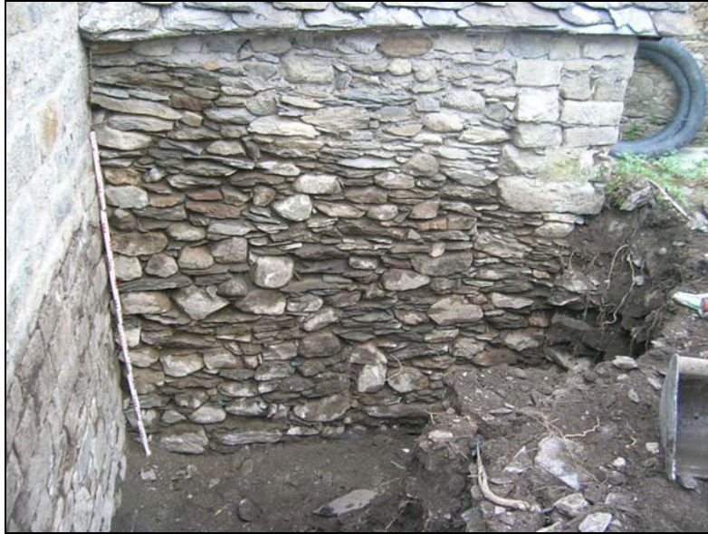
Vista general de la rasa efectuada per la instal·lació del tub per l'absorció d'humitats.
