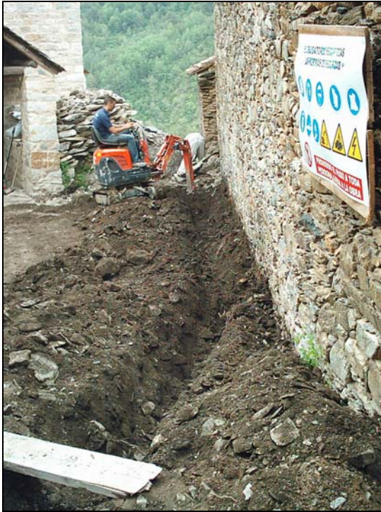
Procés de realització de la rasa per passar els cables de la llum.
