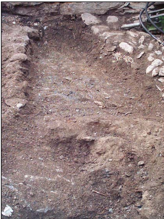
Rasa ubicada a l'entrada de l'església per impedir l'entrada d'aigua de la pluja a dins de l'edifici.
