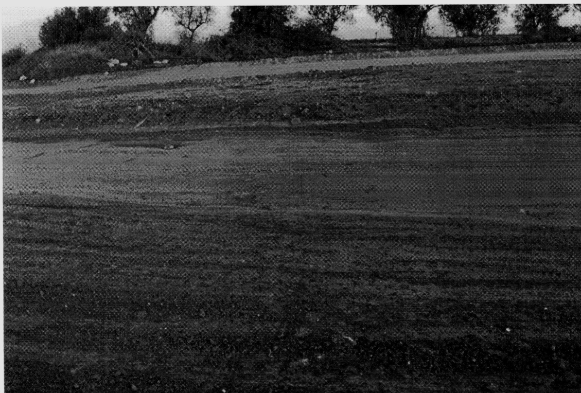
Fig.17 Vista parcial de la pista de rally i situació de les pedres abans de la intervenció.
