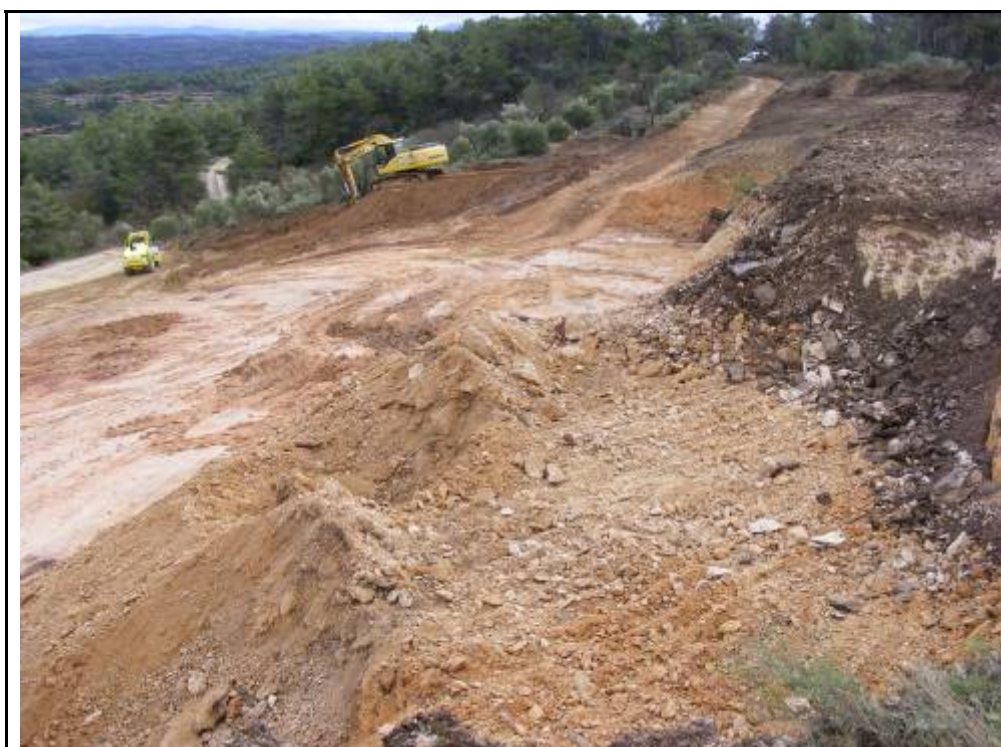
Foto 33: control dels rebaixos a la S.E.T del P.E. de Sant Antoni.
