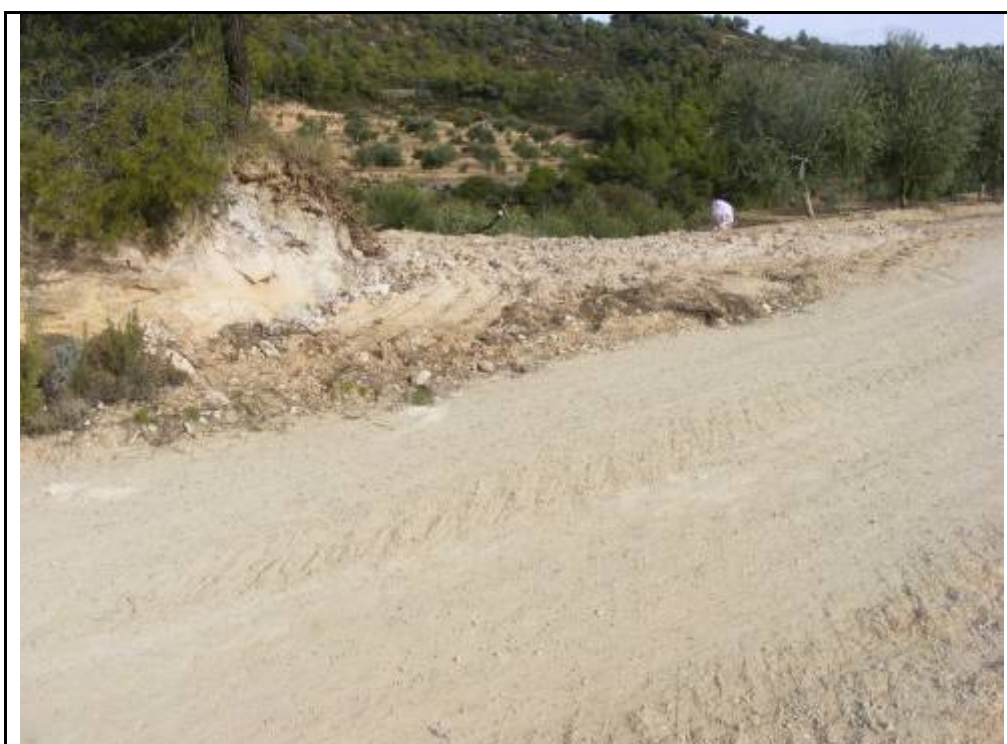
Foto 120: Suport 11, rebaixos per la realització de l'accés a la plataforma des del camí de la Vall de Sant Pere
