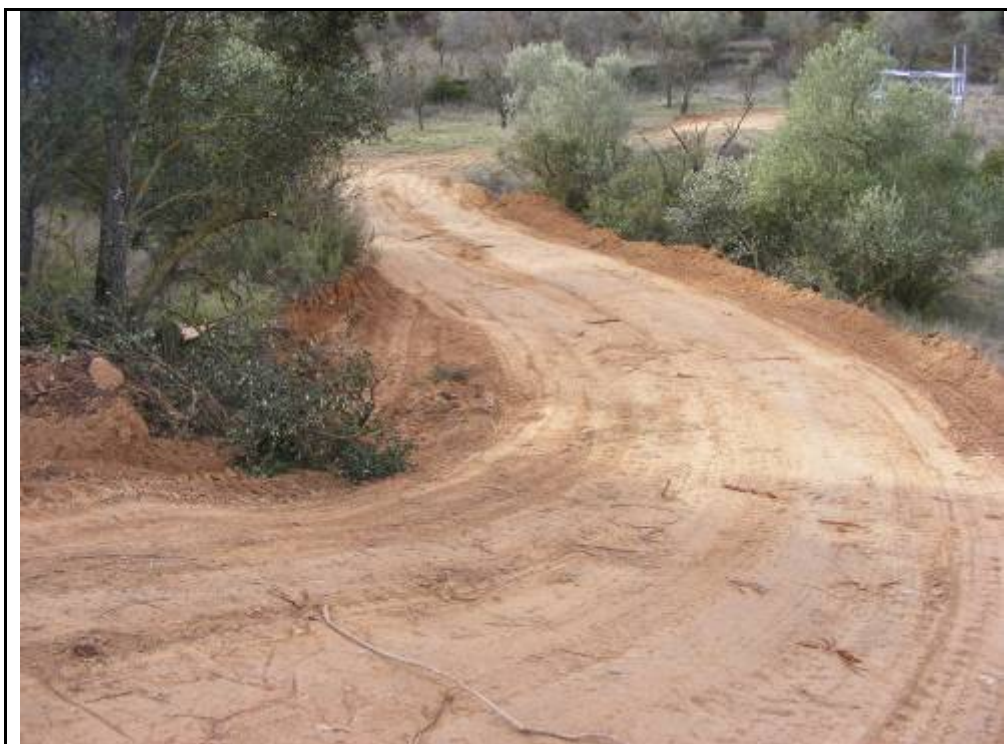
Foto 85: Suport 24, zona talada, desbrossada i terraplenada per l'ampliació i confecció del camí d'accés a la plataforma.
