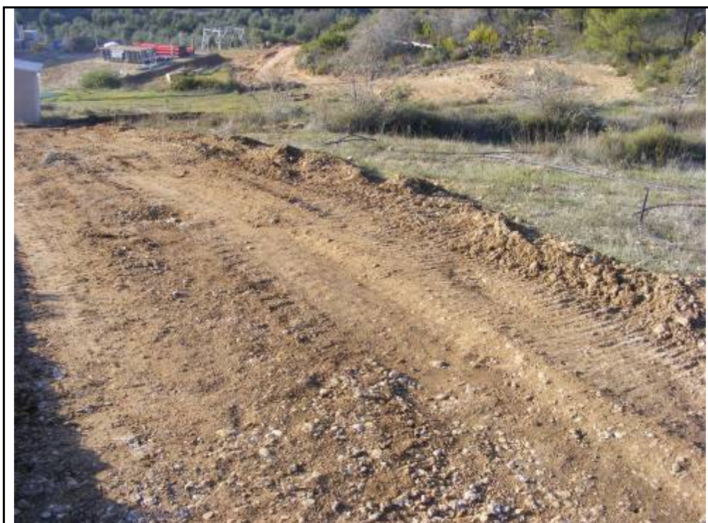
Foto 142: Suport 1, zona desbrossada amb rebaixos i terraplens per la confecció del camí d'accés a la plataforma.
