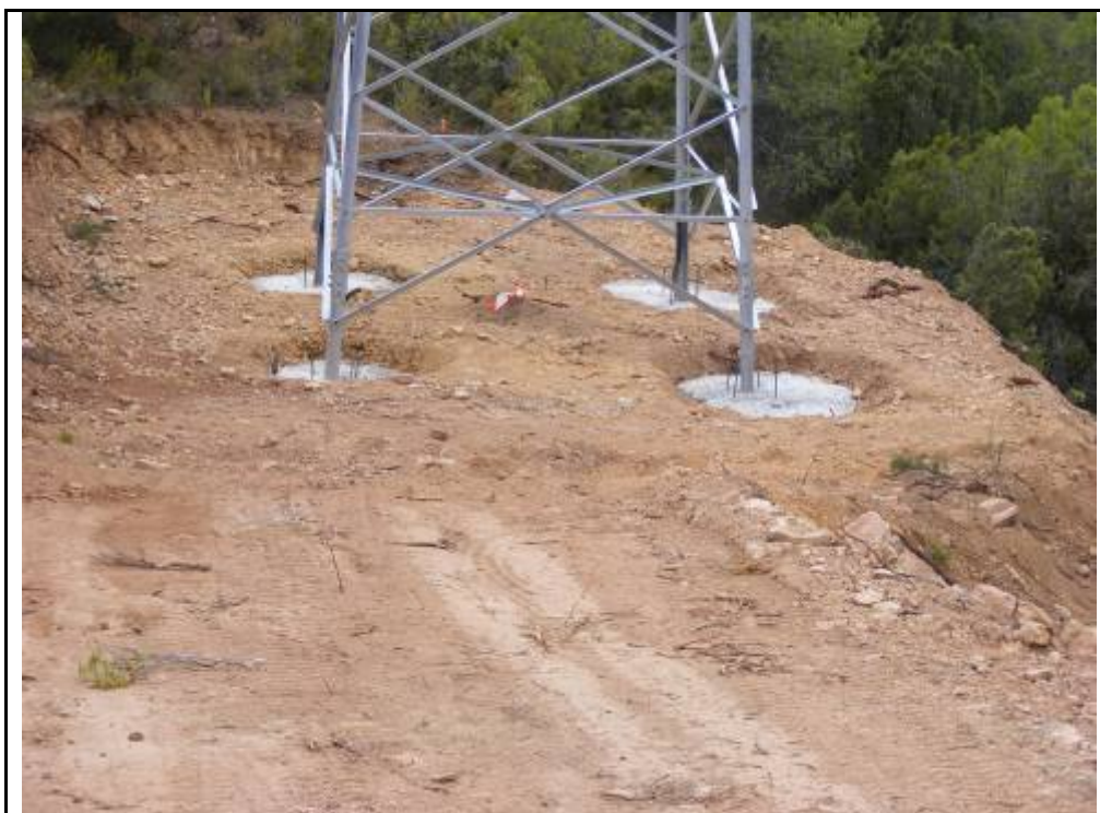
Foto 75: Suport 27, zona amb rebaixos i terraplens per la confecció de la plataforma.
