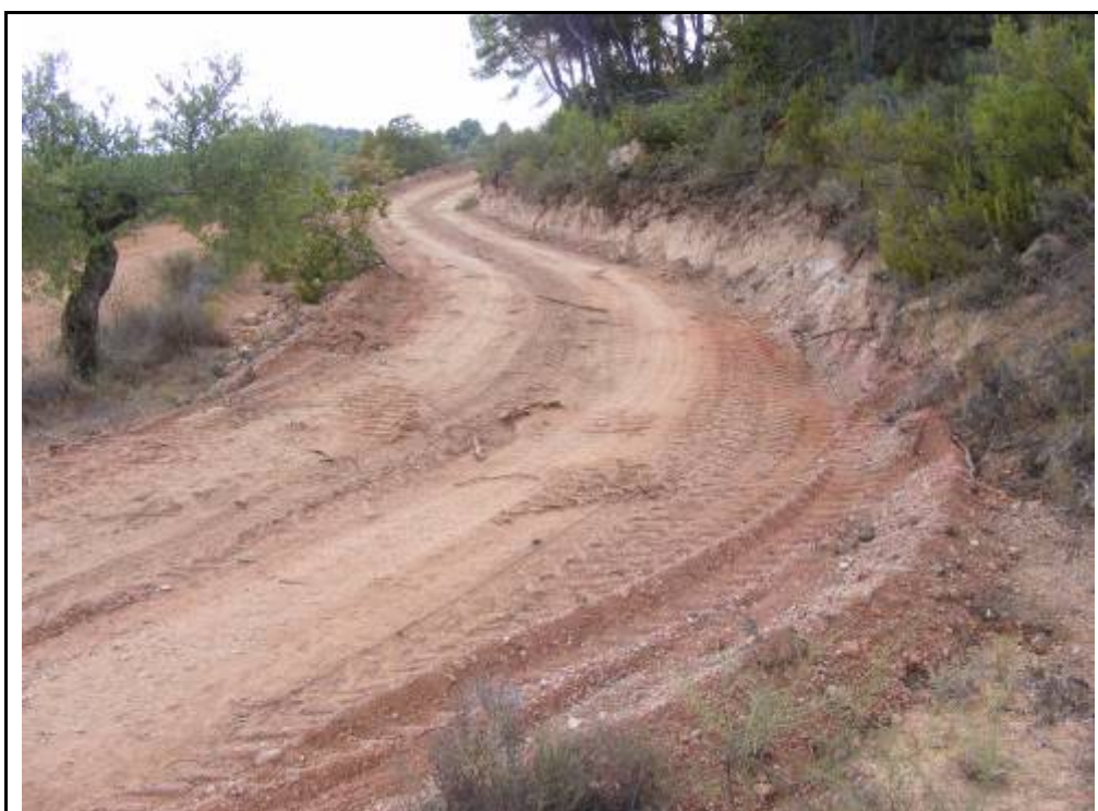
Foto 100: Suport 19, zona amb rebaixos per l'ampliació del camí d'accés a la plataforma.
