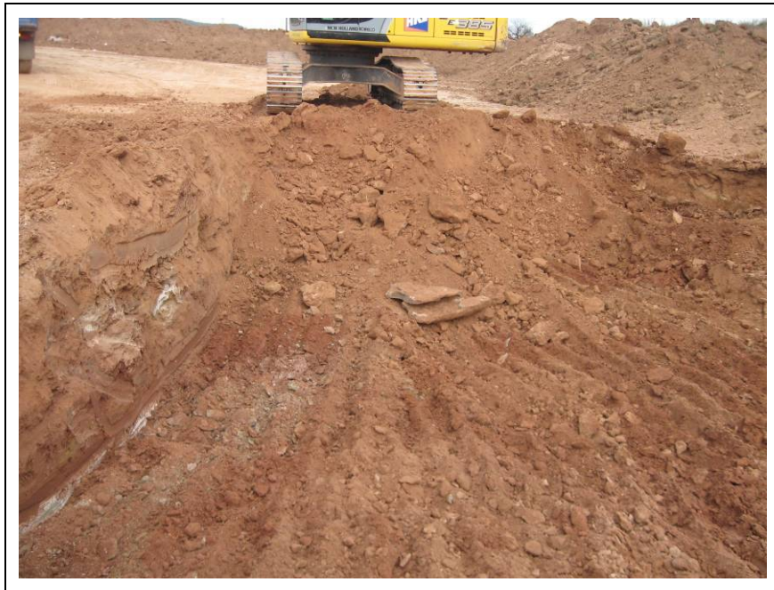
Foto núm.8, treballs d'excavació e les terres on apareixen les capes de carbonatacions.
