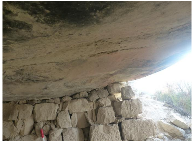
4. Vista del sostre a la zona de l'entrada, rubefactat i la part superior del mur de l'est de la balma.
