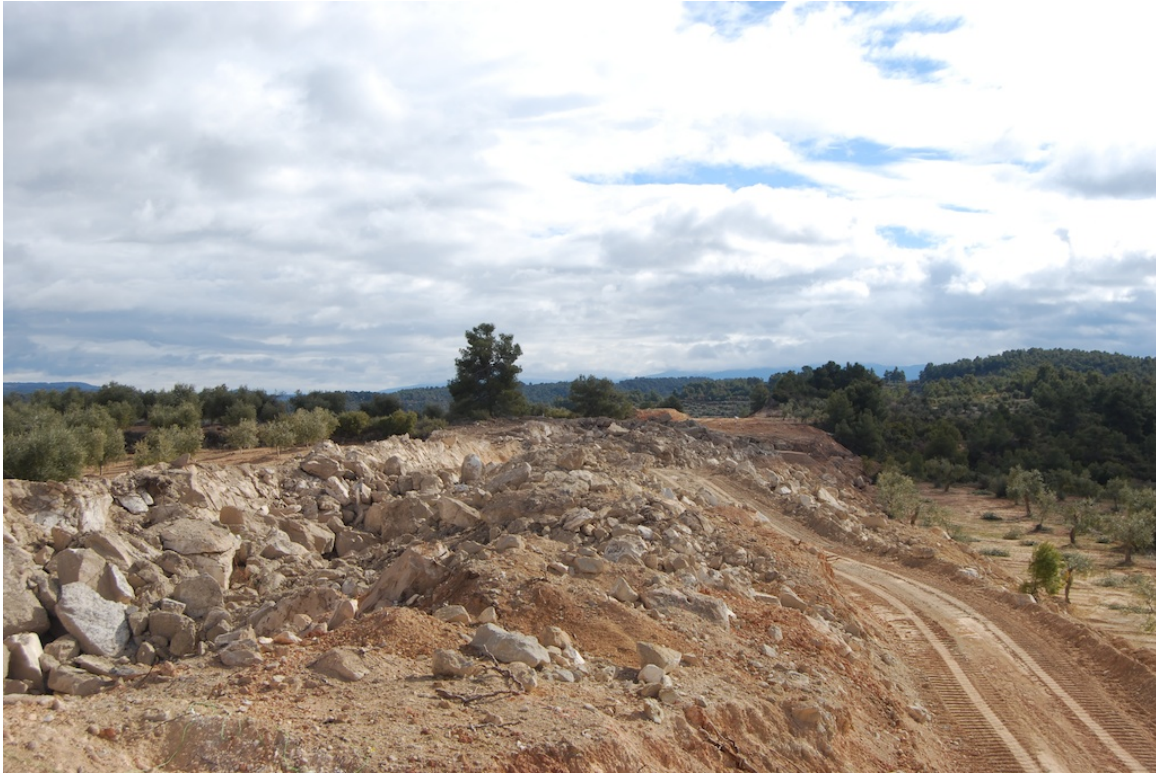
Vista de l'obra de construcció del camí de l'Albagés a Cervià, Serra dels Fontanets, febrer 2011
