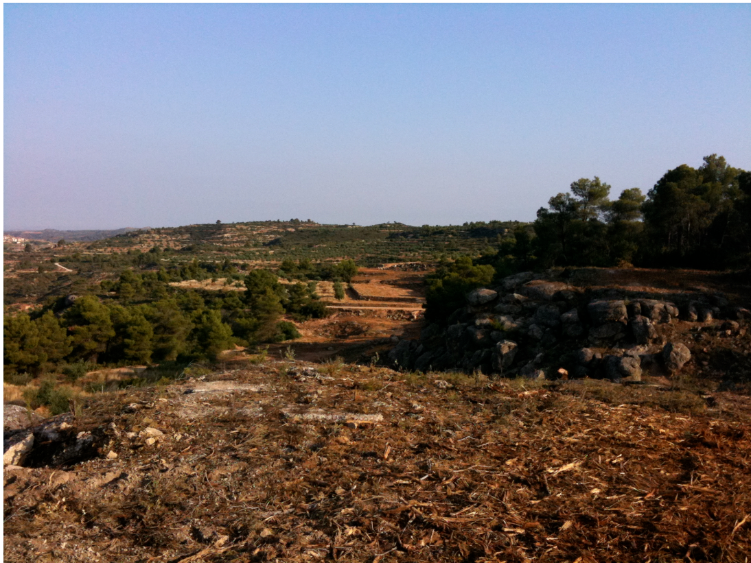
Vista de l'obra de construcció del camí de l'Albagés a Cervià, Serra de Fontanets, juliol 2011
