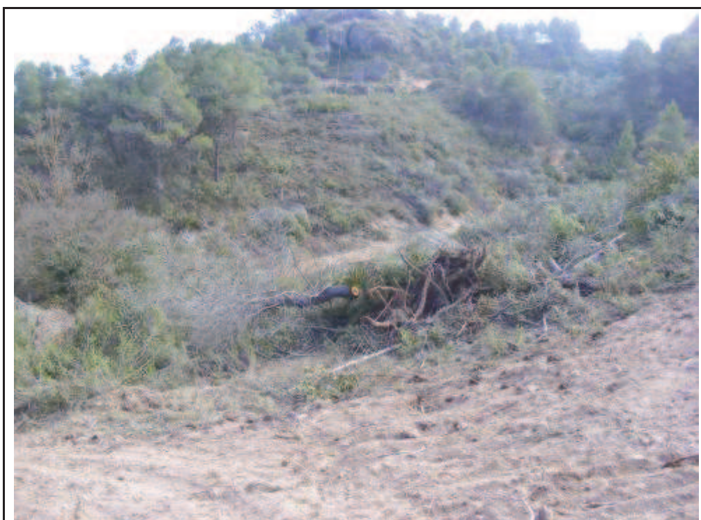
Foto 92: Zona talada entre el suport 22 i el suport 21.
