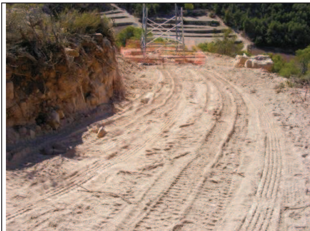
Foto 62: Suport 2, zona amb rebaixos i terraplens per la confecció de la plataforma.
