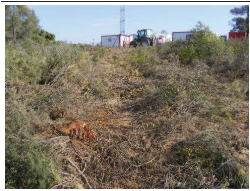
Foto 30: Traçat de la LE Entre els suports 15 i 16, s'ha talat una zona de bosc i matolls.
