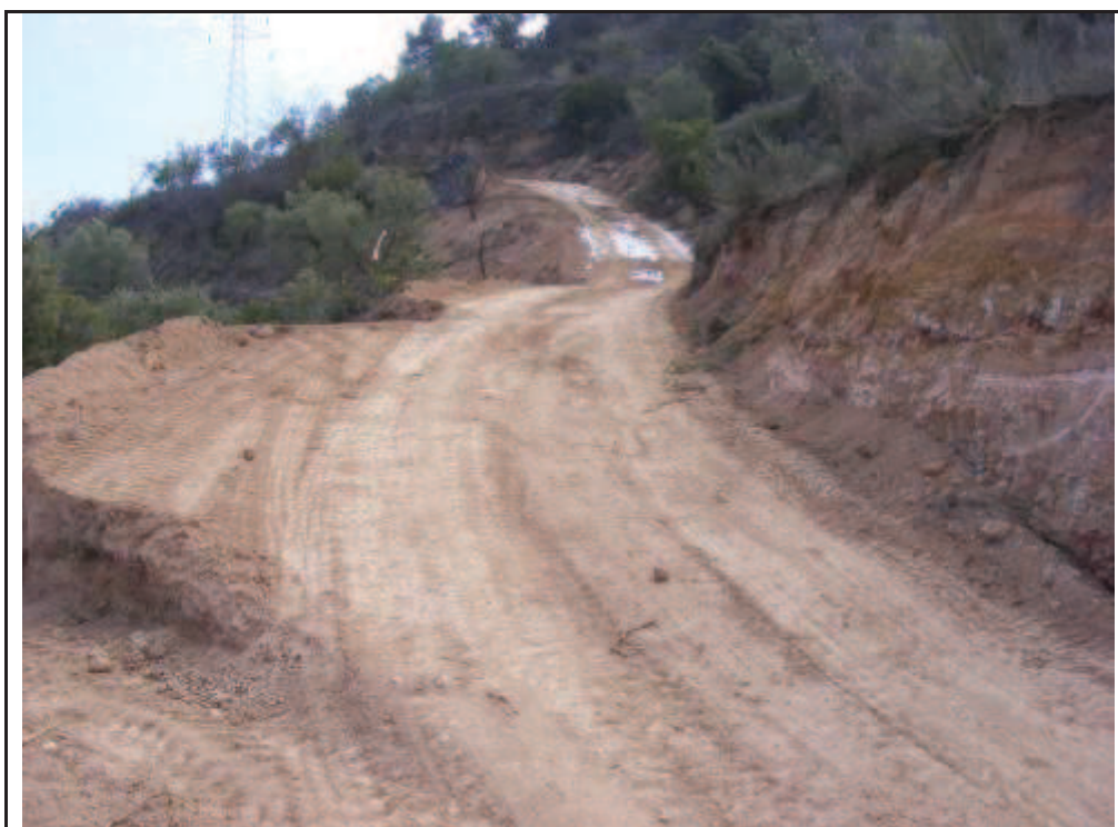
Foto 88: Suport 23, zona talada, desbrossada i amb rebaixos per la confecció del camí d'accés a la plataforma.
