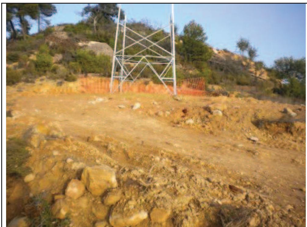
Foto 138: Suport 3, zona talada amb terraplens i rebaixos per la confecció dels quatre pilars, i zona amb rebaixos i terraplens per la confecció de la part final del camí d'accés a la plataforma.
