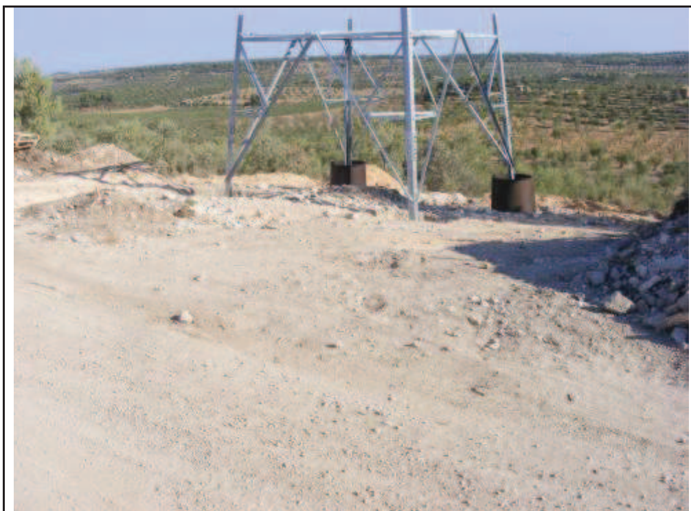
Foto 2: Suport 2, zona davant la SET del PE de Monclues.
