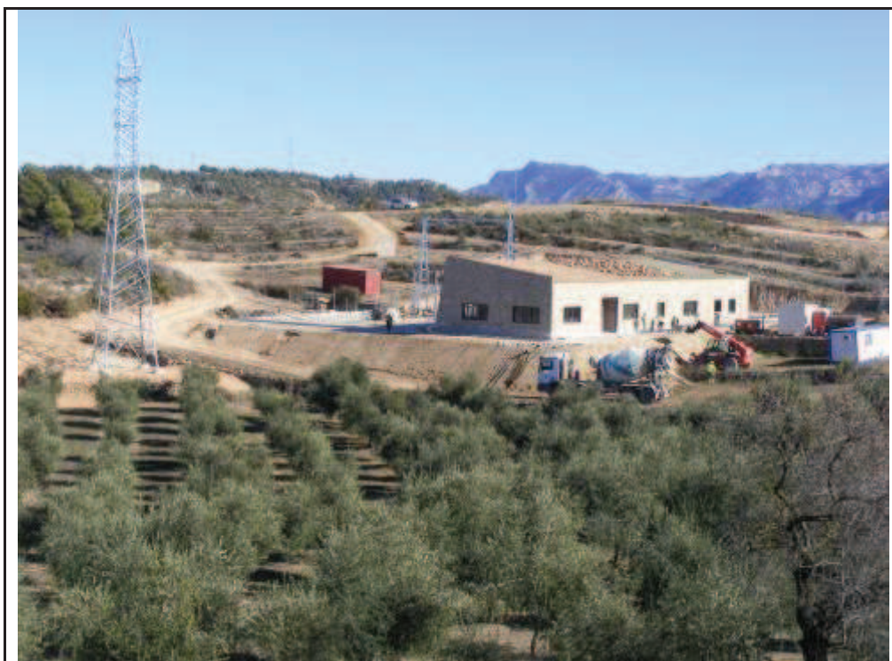
Foto 145: SET de les Rotes, zona ja construïda.
