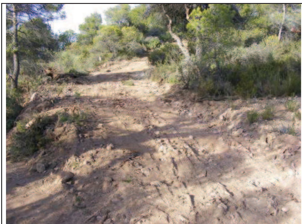
Foto 128: Suport 8, zona talada i desbrossada amb rebaixos per la confecció del camí d'accés a la plataforma.
