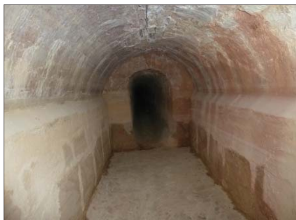
Figura 12. Vista del dipòsit situat a l'inici de la xarxa de distribució d'aigua a l'interior de la cartoixa. Al fons, l'arribada de la mina.
