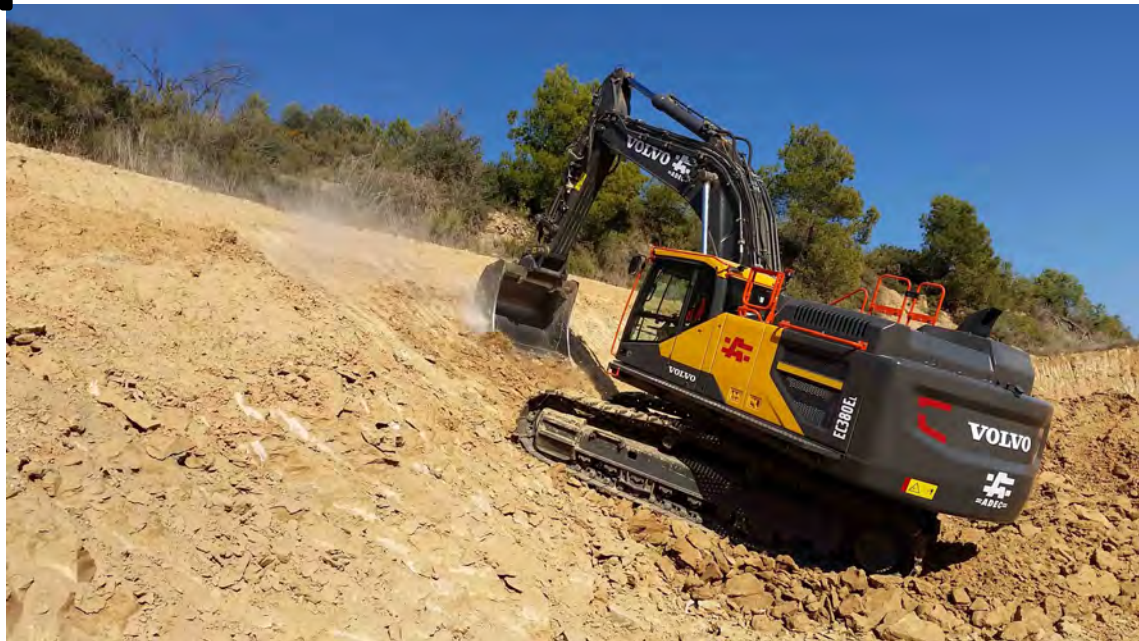
Figura B.10. Imatge de la giratòria excavant al talús més al N del sector PCM el 25/01/18.
