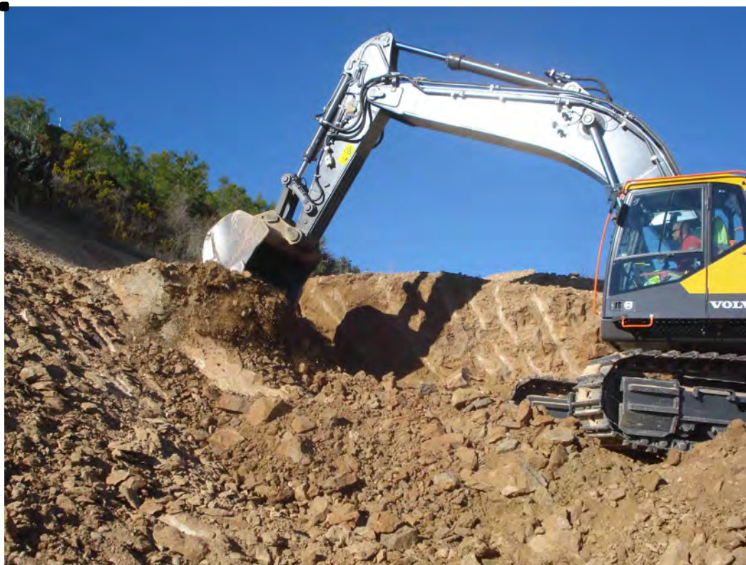
Figura B.5. Imatge de la giratòria Volvo EC380E excavant sediments miocens al talús NO del sector PCM el 04/01/18.
