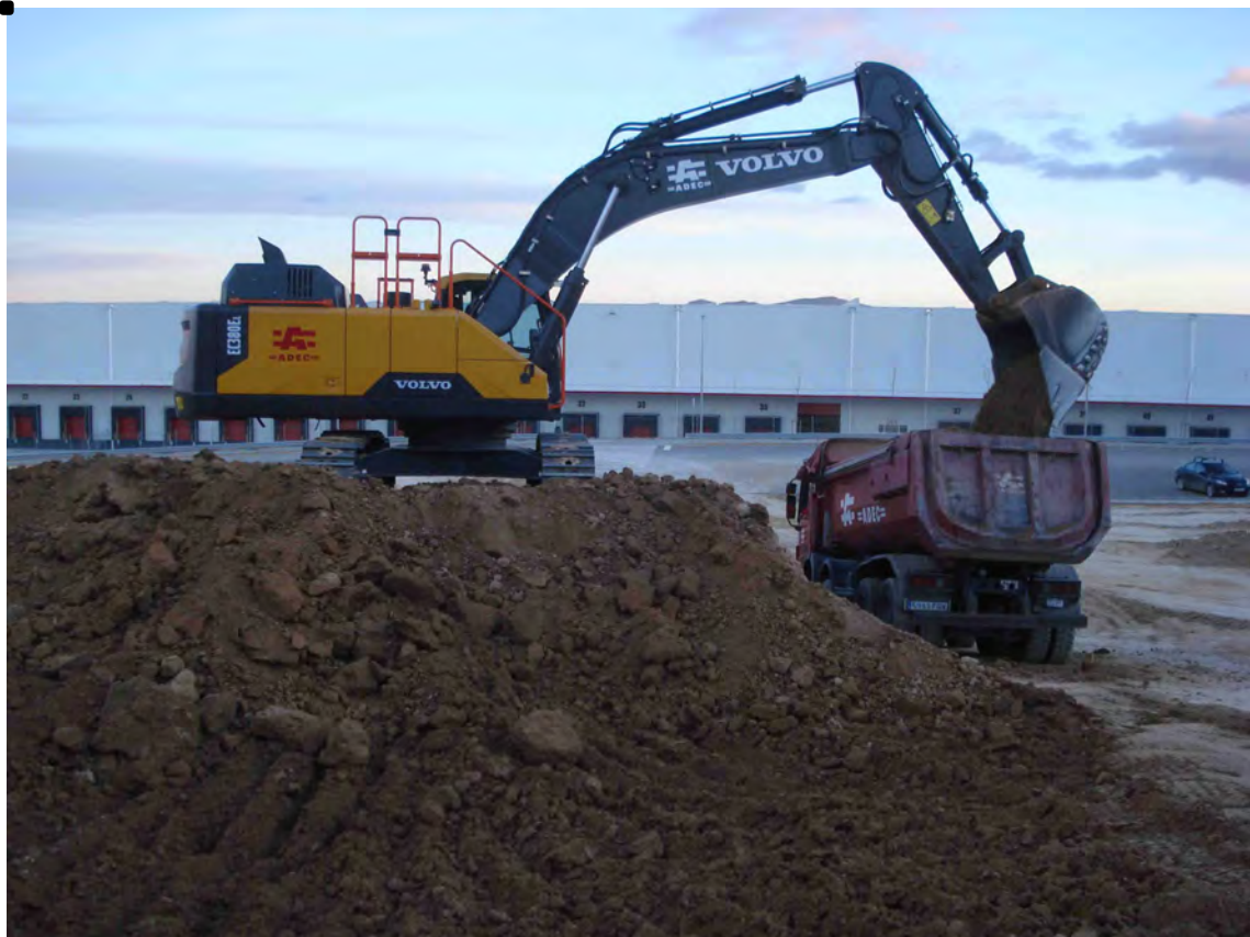
Figura B.3. Imatge de la giratòria Volvo EC380E carregant sediments remoguts a la part S del sector PCM el 02/01/18.
