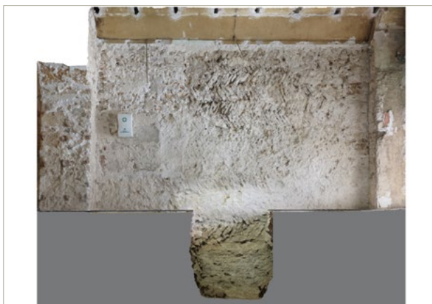
Figura 1. Ortofotogrametria del pany de paret d'obra en espiga (s. XIII-XIV) localitzat a la planta baixa de la finca. L'estructura tenia continuïtat al primer pis, on encara es podia apreciar el pendent de la coberta de l'edifici original.
