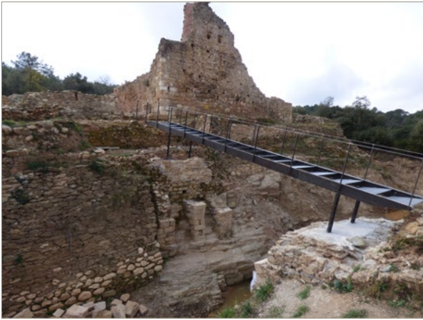
Figura 2. Detall del nou pont metàl·lic.
