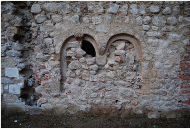
Figura 1. Finestra geminada de la façana interior de l'ala est del claustre. Es pot apreciar al brancal dret com els carreus que conformen l'obertura estan disposats de forma que coincideixen amb les filades de l'aparell del mur. 17/NOV/2021 (E. Píriz).
