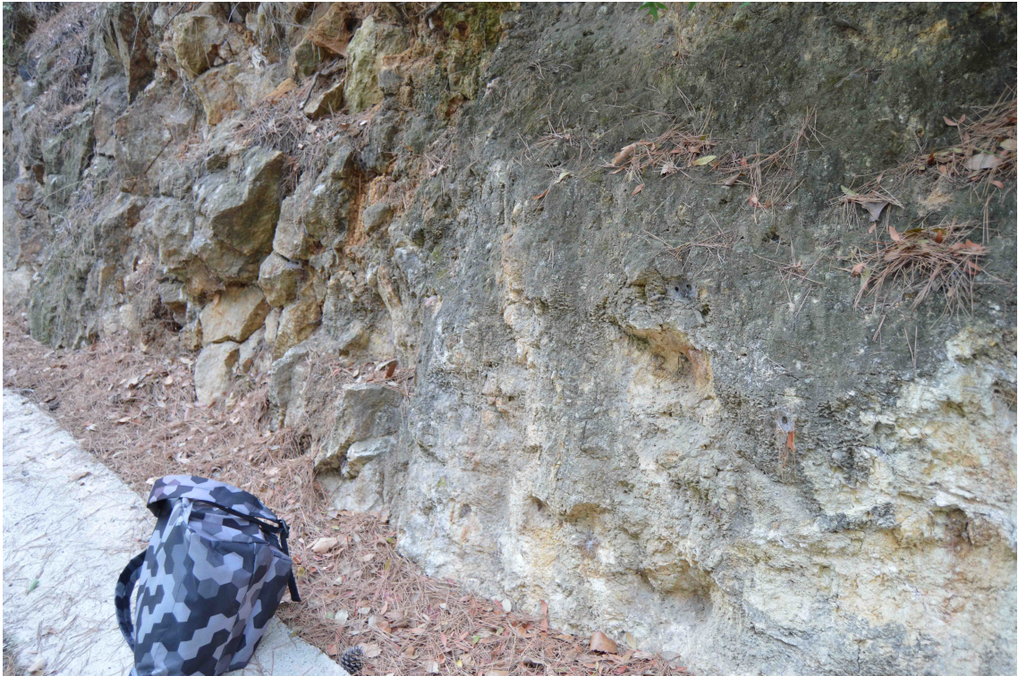
Fig. 6. Fotografia corresponent a la lletra "C" de la Fig. 3, on s'hi pot observar el contacte mitjançant una falla entre els material granítics (a l'esquerra de la bossa), i els materials miocens (a la dreta de la bossa).
