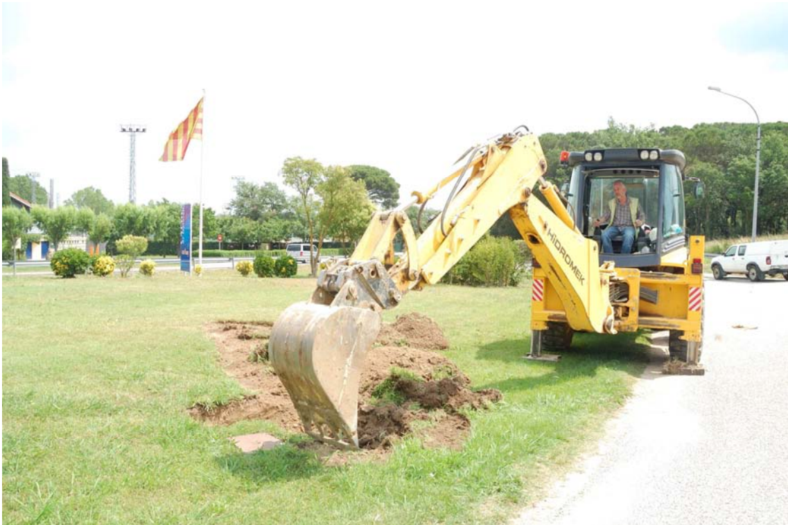
Fig. 12. Rebaix de la zona verda per a la construcció de la rotonda.
