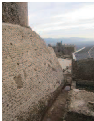
255 - Fotografia de l'estat actual del conjunt d'edificacions del sector Nord-Oest del Pati d'Armes, on destaca el potent talús contrafort, de 14 metres d'alçada, que protegeix el recinte Sobirà
