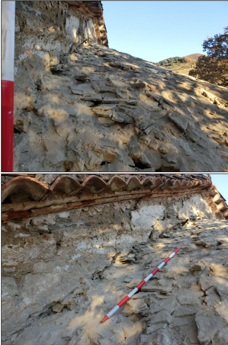
Figura 7: Absis enllosat. En aquestes imatges es pot observar com la nova coberta d'enllosat talla la cornisa de sosteniment de la coberta original de la nau
