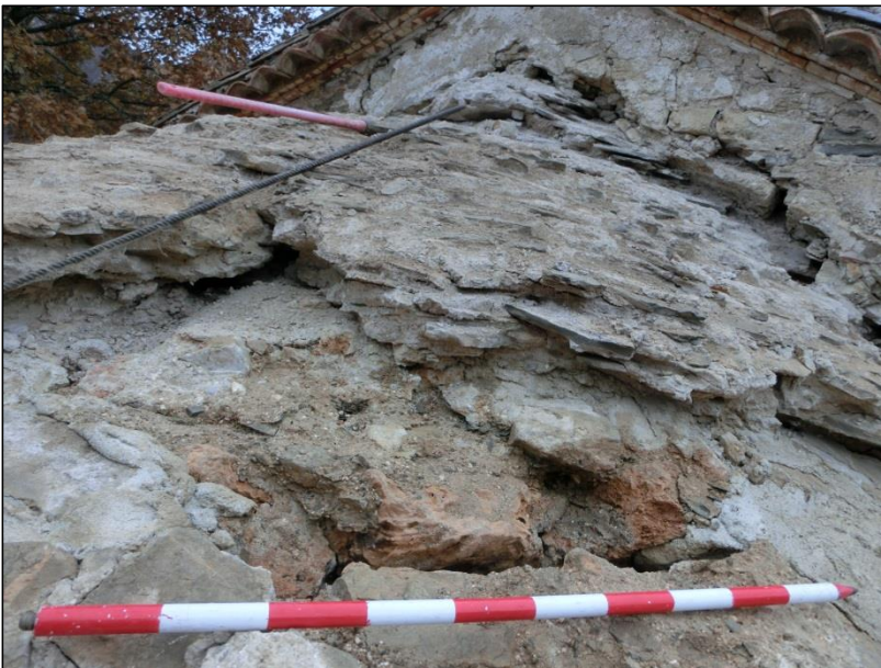
Figura 8: les esquerdes de la coberta deixen visible els elements de la volta.
