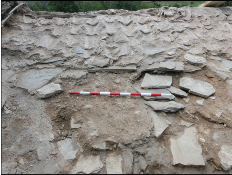
Figura 21: Vessant sud. Per sota la preparació de la darrera, s'observa una segona coberta – parcial- de teules, amb un carener de lloses reaprofitat com a base del carener de teules superior i les lloses que apareixen per sota de la segona coberta.
