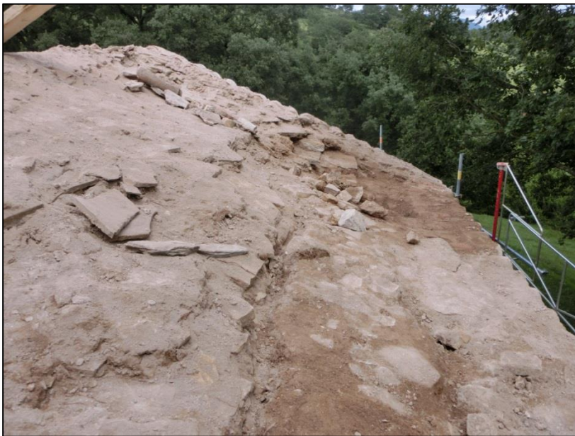
Figura 20: aspecte del vessant nord i el vessant sud un cop retirada la primera coberta de teules. Esquerdes longitudinals en sentit oest-est.
