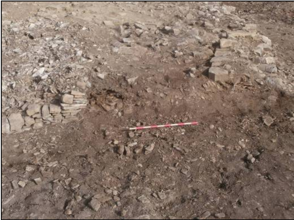
Fotografia 31: Porta en el mur perimetral, amb l'alçat de la banda oest amb pedra seca, molt inestable.
