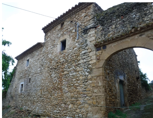
2. Cara exterior de la muralla oest integrada en el mas posterior. A la dreta, el portal, els brancals del qual pertanyen a la fortificació.
