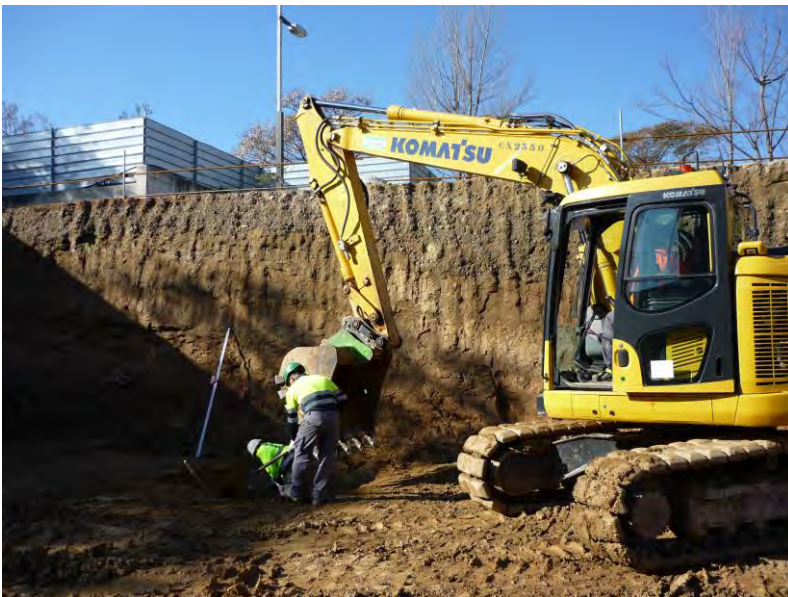
Figura 8. Excavadora giratòria Komatsu model PC138_US amb nº de Sèrie CX2350, amb cadènes, amb pales intercanviables de 1'70 m, 1 m i 60 cm d'amplada. Efectuant la obertura de la trinxera perimetral oest en el sector sud.
