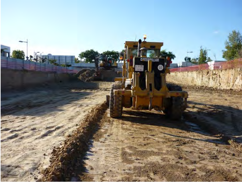
Figura 7 Una motonivelladora Caterpillar model C6.6 del 2008 amb número d'identificació CAT0012MEB9F00239. Aquesta maquina es va seguir tant per l'acció de retirar el fang acumulat, com per anivellar la cota.
