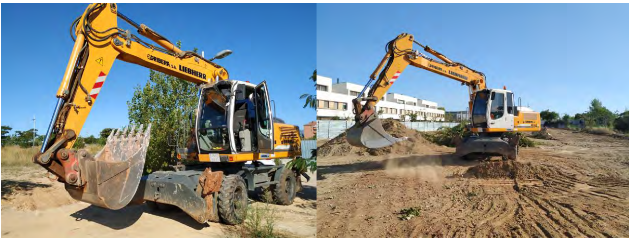
Figura 4 Excavadora giratòria Liebherr Type A914C de l'any 2008 amb matrícula E3547BFF amb rodes. S'emprà per arrencar els arbres i realitzar els primers dies d'excavació del terreny.
