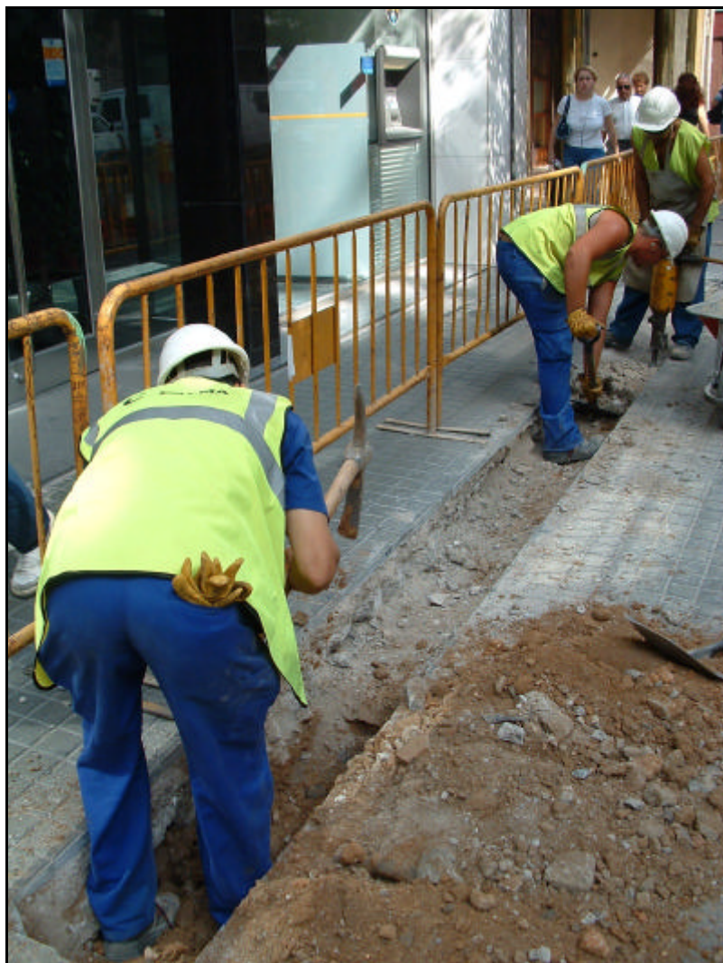
Fotografia 3. Treballs de buidatge de terres a la rasa del carrer Fontanelles, en direcció Plaça Urquinaona.
