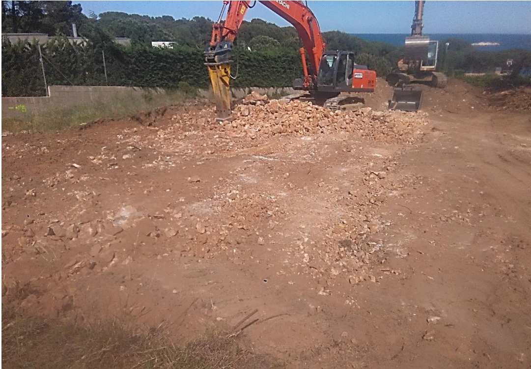
Fig. 13. Inici dels treballs de picament de la roca present a tota la parcel·la (UE 1001).
