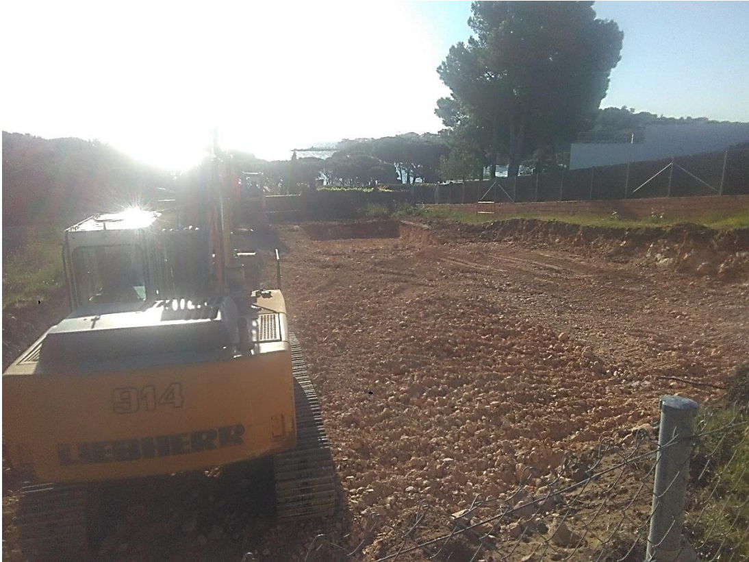
Fig. 21. Vista de la parcel·la amb els treballs de rebaix del terreny finalitzats, des de l'oest.
