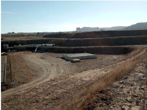
18. Tram 1 – sud. L'hidrant a tocar de la bassa d'acumulació del sistema Segarra-Garrigues.
