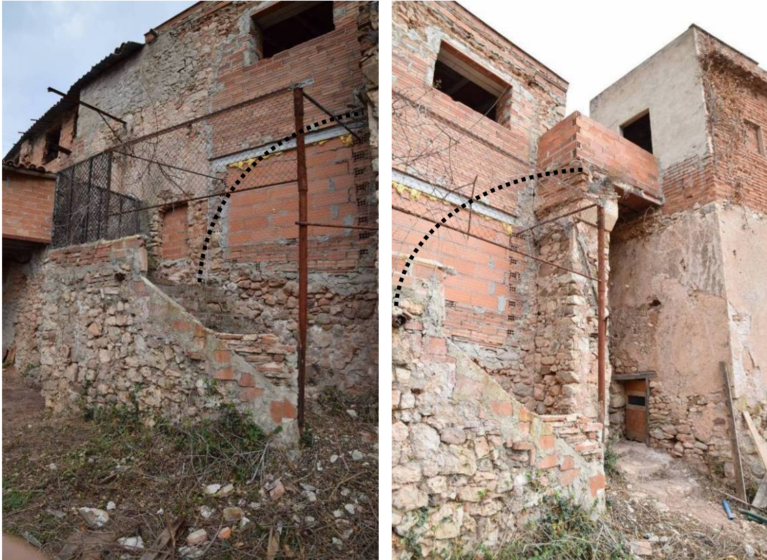
103, 104. Detall de l'escala adossada a l'àmbit VII per la cara W –E32-, que en dos trams permetia arribar al pis superior de l'àmbit XIV, aixecat durant aquesta reforma i amb accés exterior per aquest punt (traçat aproximat restituït en discontinu).
