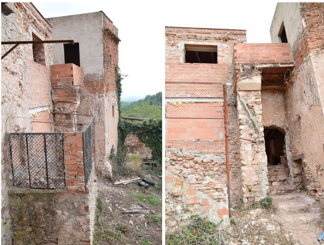
137, 138. Detall de l'escala E32 adossada als àmbits VI i VII, que donava accés al pis superior de l'àmbit XIV. A l'esquerra el replà on gira i arrenca el segon tram amb volta no conservada. A la dreta detall del darrer tram, amb el pont d'accés a la porta P62, refet amb totxanes i ciment.
