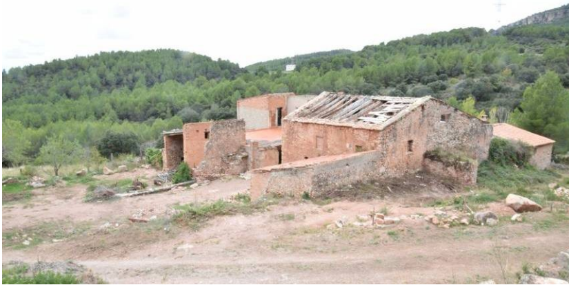
10. Vista general de Cal Batllet des del camí d'accés, en el costat NE. Es pot apreciar el desnivell del terreny. En primer terme el sector A.
