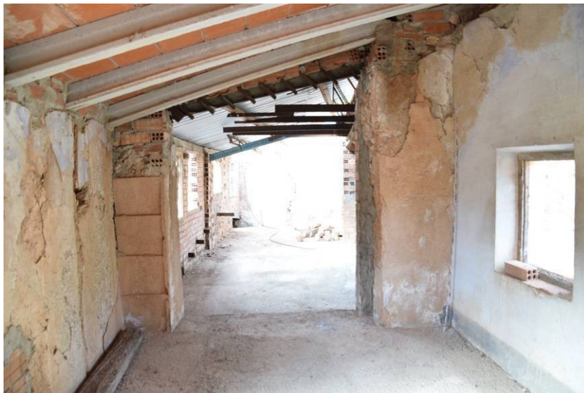
96. Vista de l'interior de l'àmbit VII en el primer pis, amb la finestra P26 a la dreta. La coberta, el terra i l'obertura que connecta amb l'àmbit VI, al fons, són fets en data recent.
