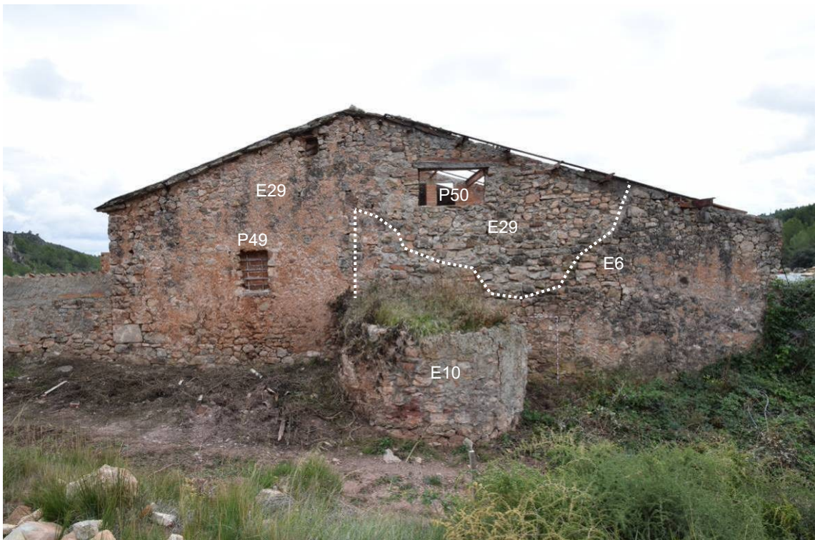
69. Detall de la façana nord de la zona alta del sector A. Indicat el punt per on es va haver de refer el tram de façana original E7 quan s'afegeix el nou cos oriental amb la paret de façana E29 i s'adossa el forn E10.
