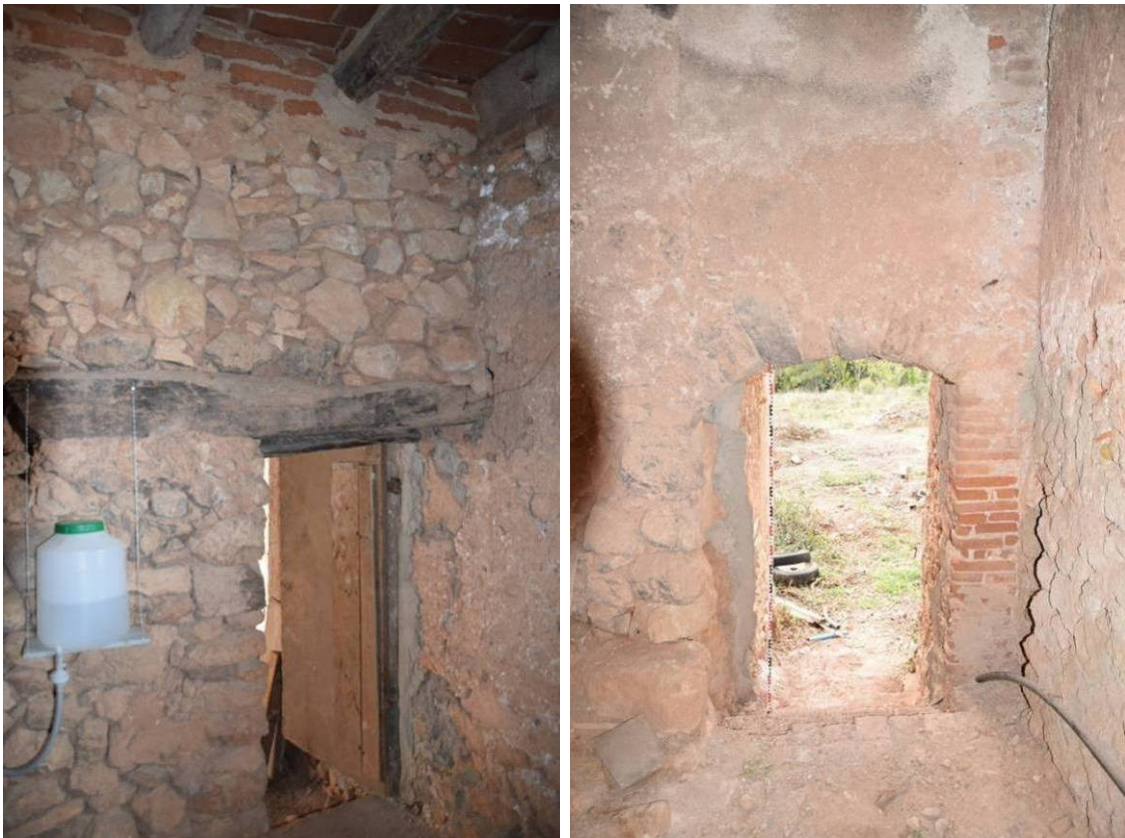
126, 127. Esquerra: detall interior de la porta P33 oberta a la paret E47. Dreta: detall de l'arc P35 que dona accés al passadís amb escala E46.
