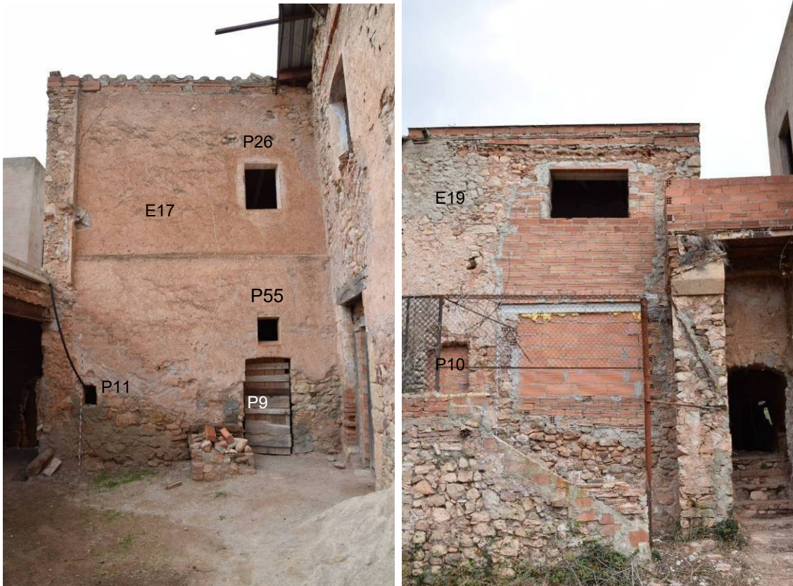
94, 95. Esquerra: detall de la façana est de l'àmbit VII, amb la porta d'accés des de l'exterior P9 i les diferents finestres de planta baixa -P55 i P56- i del primer pis -P26-. Dreta: detall de la façana oest de l'àmbit VII, en gran part reconstruïda en època recent amb totxanes i ciment. Indicada la finestra original P10.
