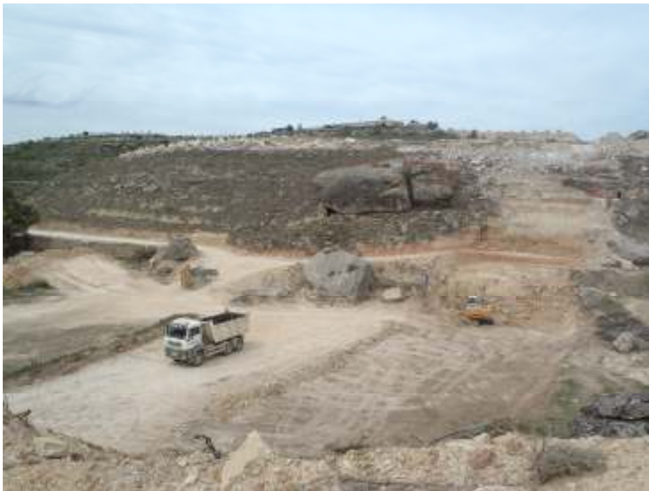
Imatge del Fondo de la Roca del Llamp rebaixat i excavació de la sabata per a l'aqüeducte; a la vessant del turó, el jaciment de Roca Llamp
