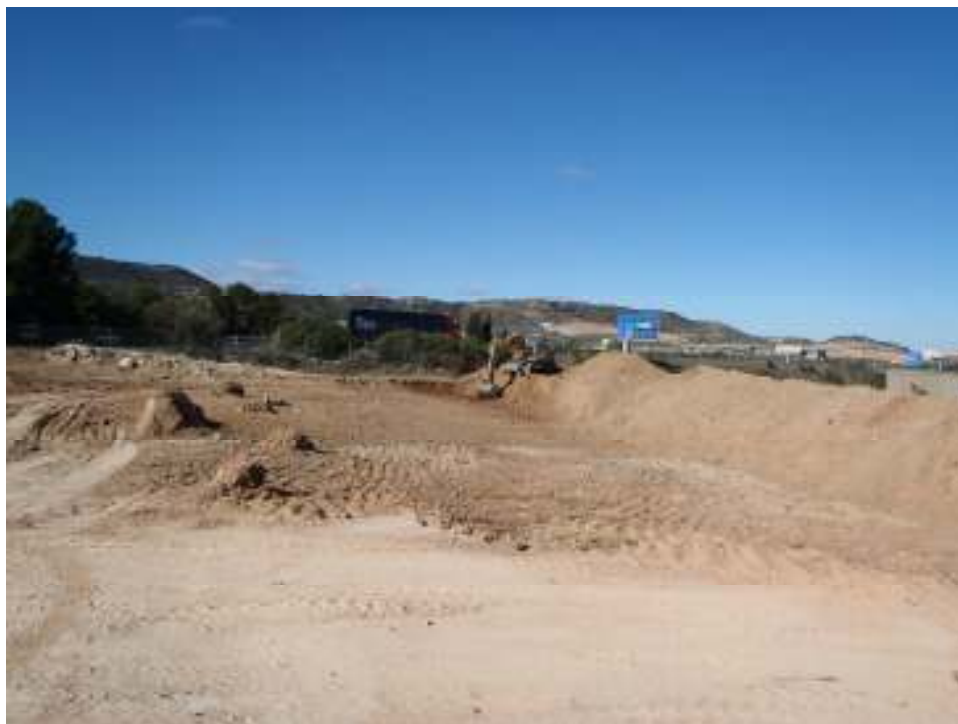
Imatge de l'excavació a la banda oest de la traça del canal entre els PPKK 77+920 i 77+840
