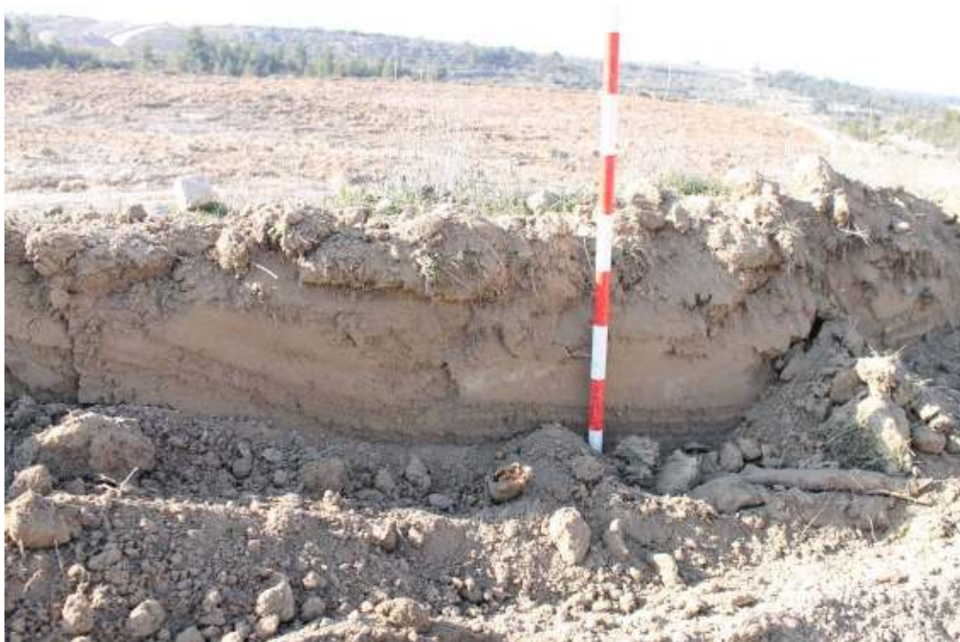
Imatge de la secció dels rebaixos de l'obra un cop extreta la capa de terra vegetal al PK 67+800
