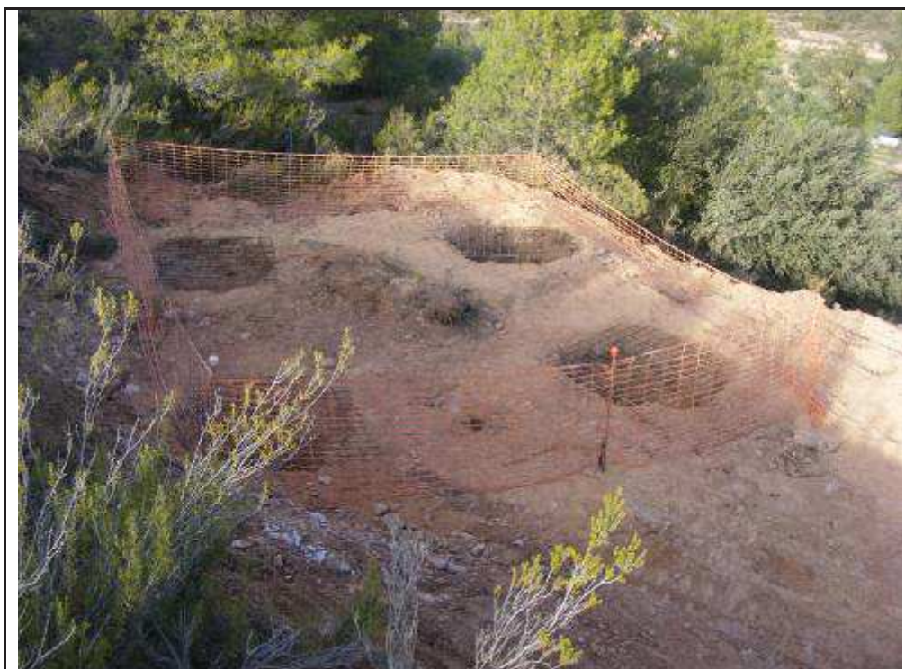
Foto 135: Suport 4, zona talada amb terraplens i rebaixos per la confecció dels quatre pilars.
