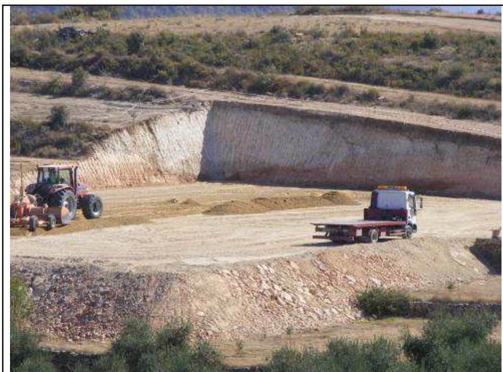
Foto 144: SET de les Rotes, terraplenament i compactació. S'han revisat totes les seccions producte dels rebaixos.
