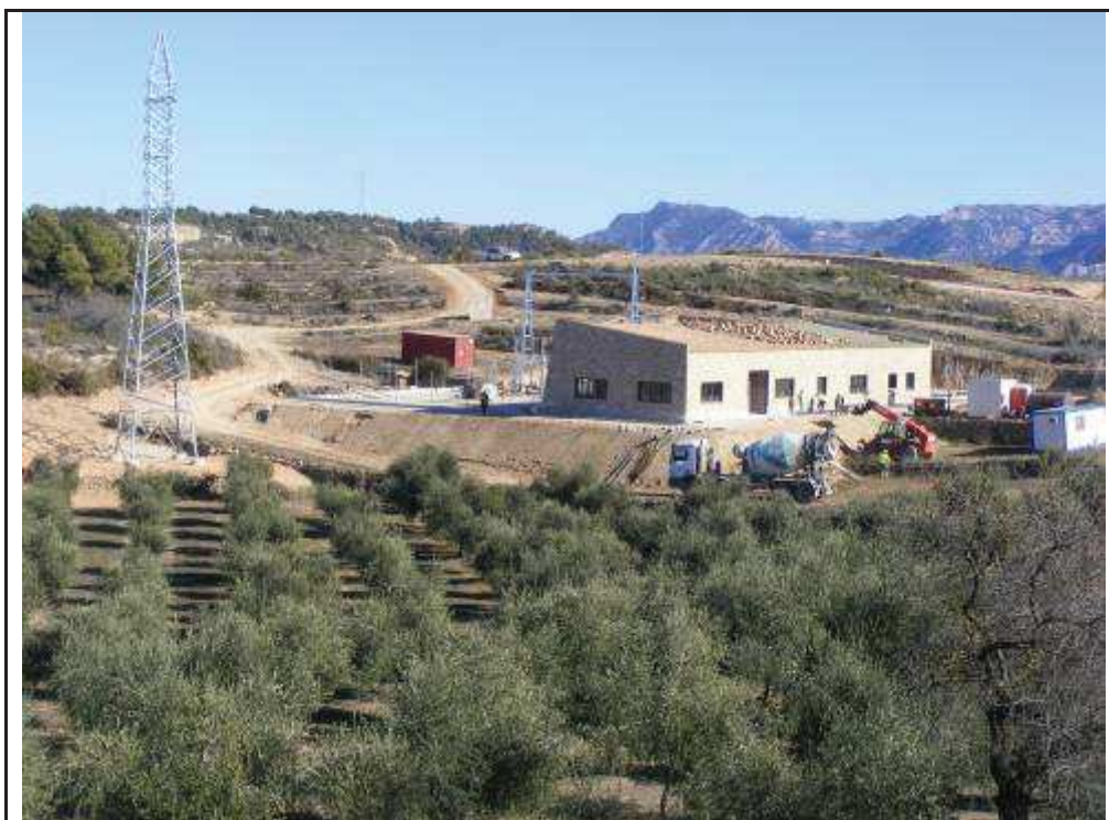
Foto 145: SET de les Rotes, zona ja construïda.
