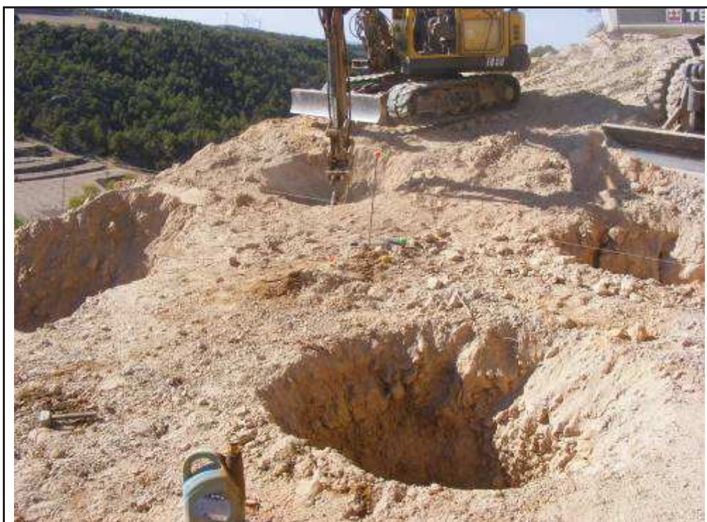
Foto 65: Suport 1 (SET Sant Antoni-SET l'Auliver), suport 31 (SET l'Auliver - SET les Rotes), zona amb rebaixos i terraplens per la confecció de la plataforma.
