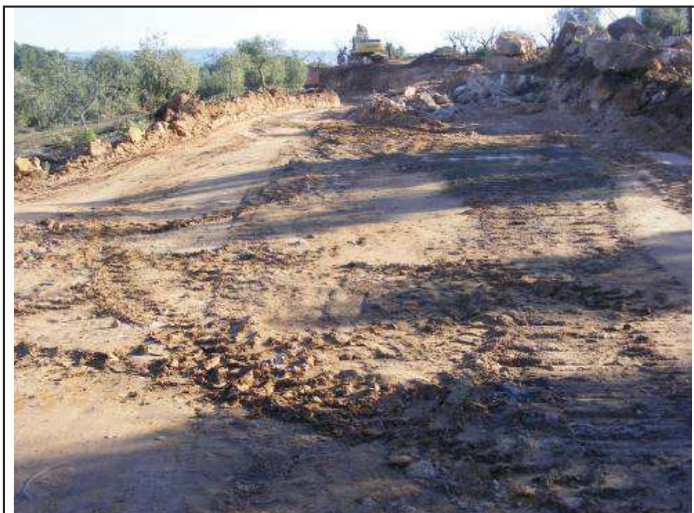
Foto 113: Suport 14: obres dels accessos al aerogeneradors 1, 2 i 3 del PE de les Rotes (camí de les Bàssies)
