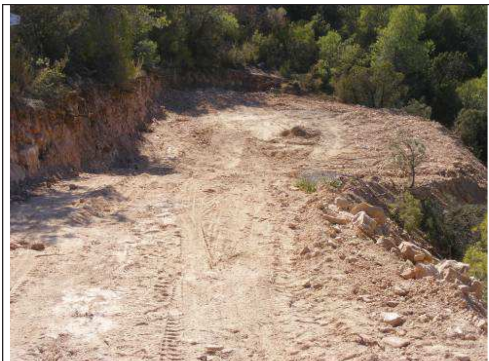
Foto 68: Suport 30, zona amb rebaixos i terraplens per la confecció de la plataforma.
