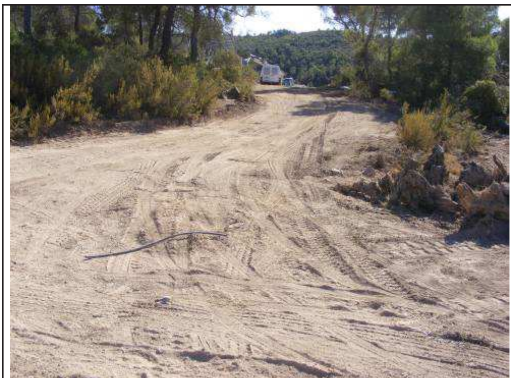
Foto 66: Suport 1 (SET Sant Antoni-SET l'Auliver), suport 31 (SET l'Auliver - SET les Rotes), zona rebaixada per la confecció de l'accés a la plataforma.
