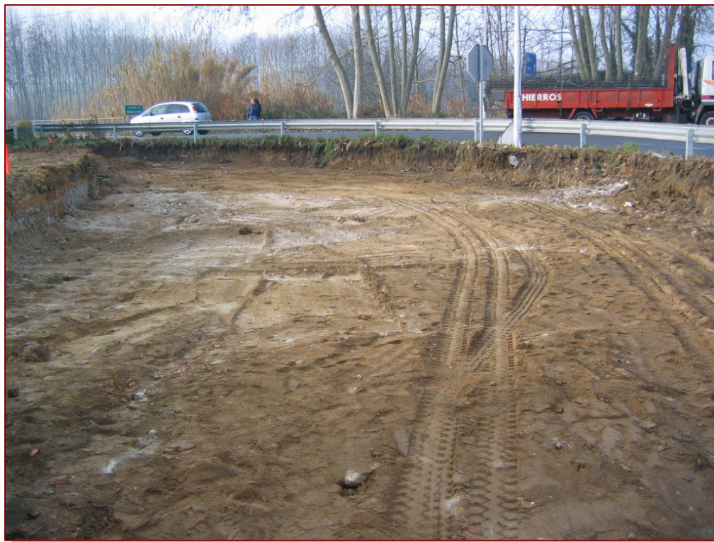
Detall d'una de les zones afectades després de fer els rebaixos.
