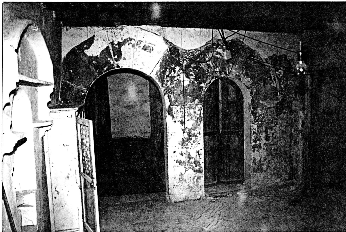
Portes d'accés a la primera planta de l'edifici des de la torre. Fase III.
