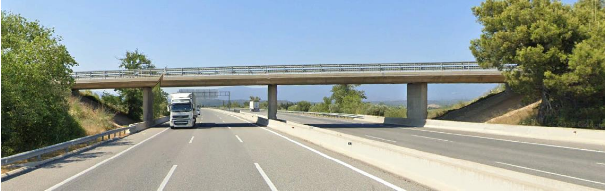
Vista de la estructura de cruce de la carretera GIV-6225 sobre la AP-7. Fuente: Google Street View.
